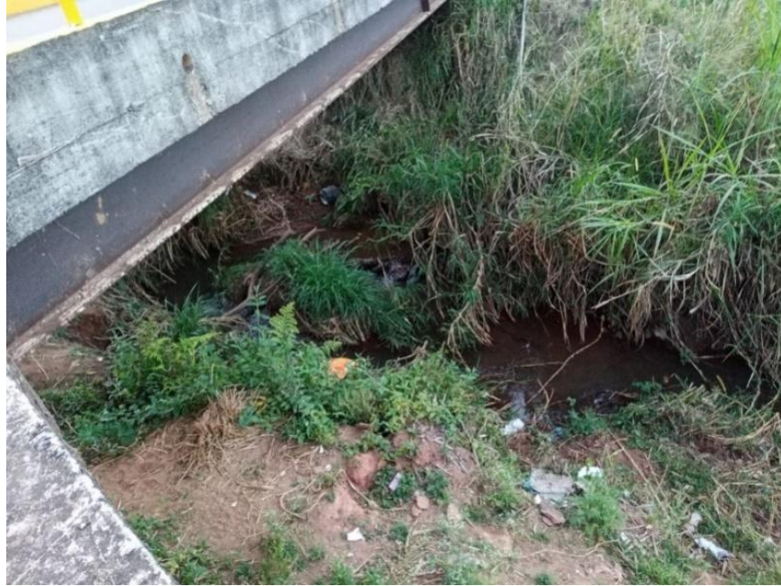
Figura 8 – Seção do córrego obstruída por vegetação e terra.
