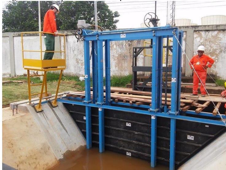
Figura 22 – Comporta Metálica Implantada em canal
