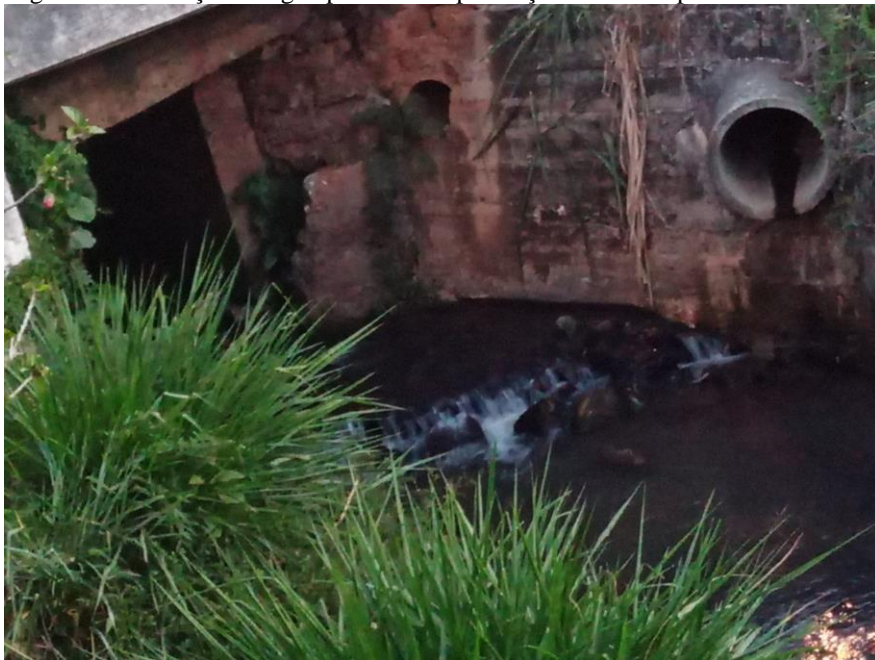
Figura 9 – Tubulação de água pluvial sem presença de um dissipador
