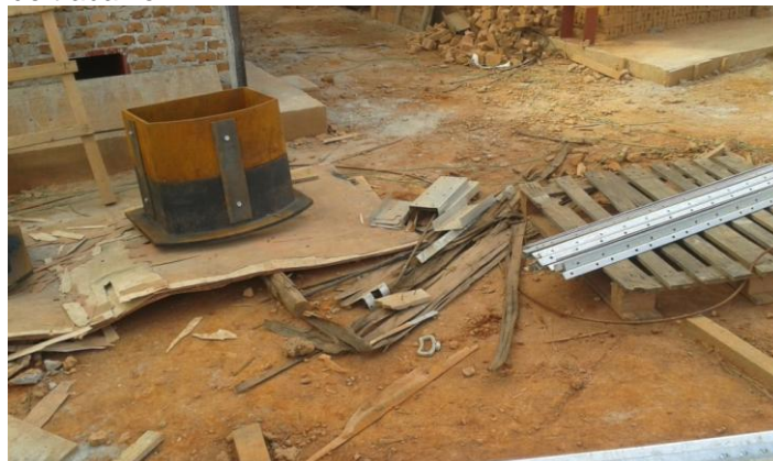
Figura 11 - Falta de organização e limpeza no ambiente de trabalho
