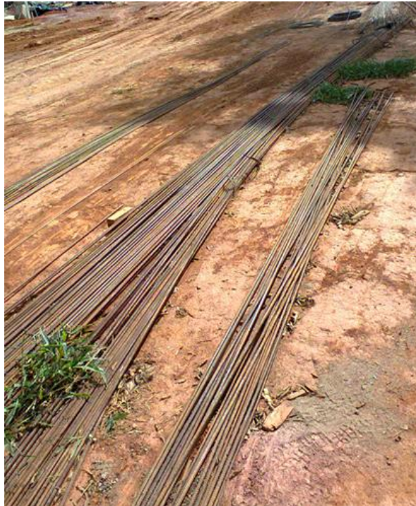
Figura 19 - Barras de aço armazenadas em contato direto com o chão
