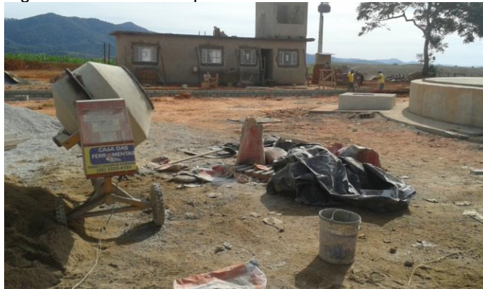
Figura 10 - Falta de limpeza no ambiente de trabalho
