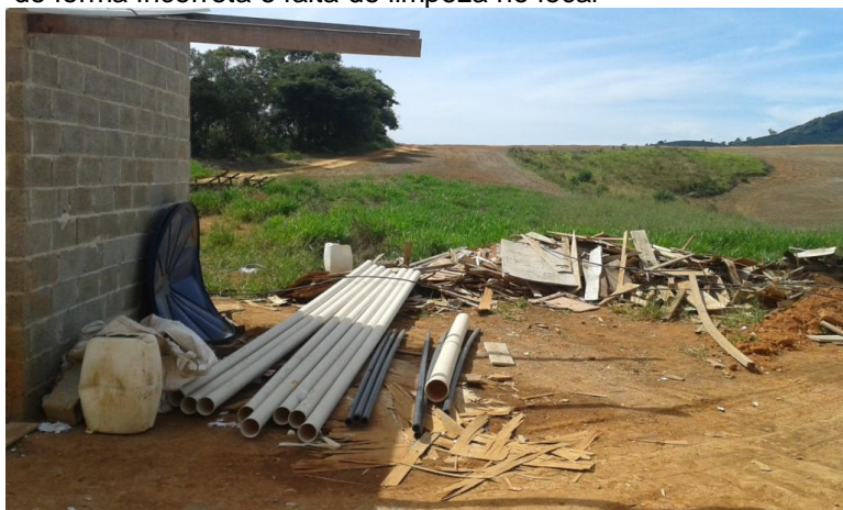
Figura 16 - Tubo de PVC e entulho de resto de materiais armazenados de forma incorreta e falta de limpeza no local
