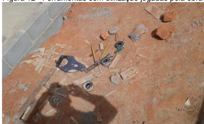
Figura 12 - Ferramentas sem utilização jogadas pela obra
