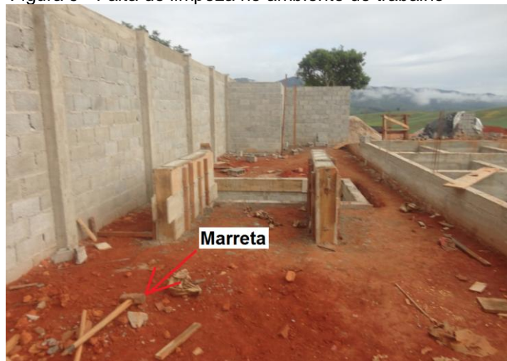
Figura 9 - Falta de limpeza no ambiente de trabalho
