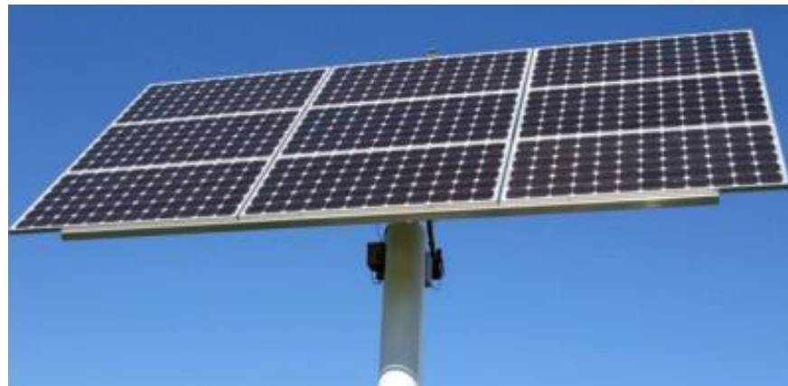
Figura 74: Painel fotovoltaico em mastro
