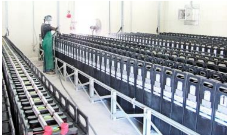
Figura 96: Banco de baterias em uma grande central PV
