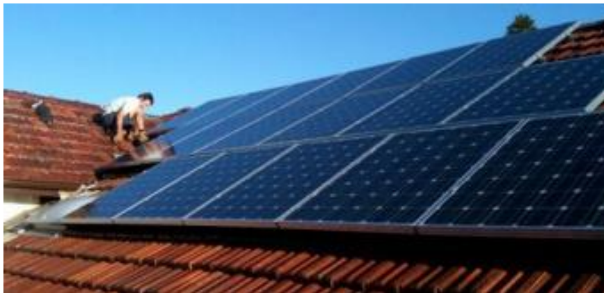
Figura 65: Painel fotovoltaico montado em telhado
