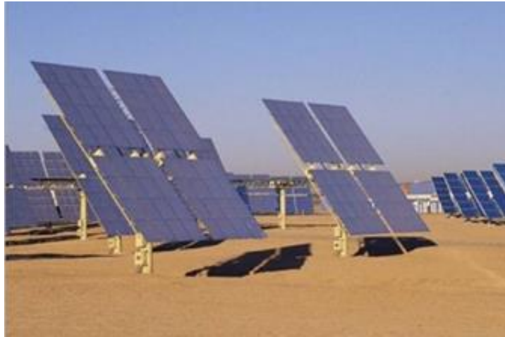
Figura 73: Painel fotovoltaico com sistema de rastreamento solar
