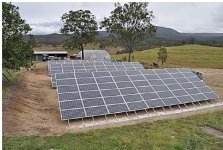
Figura 71: Painéis fotovoltaicos montados no chão, com inclinação adequada
