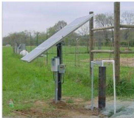
Figura 19: Sistema de bombeamento fotovoltaico
