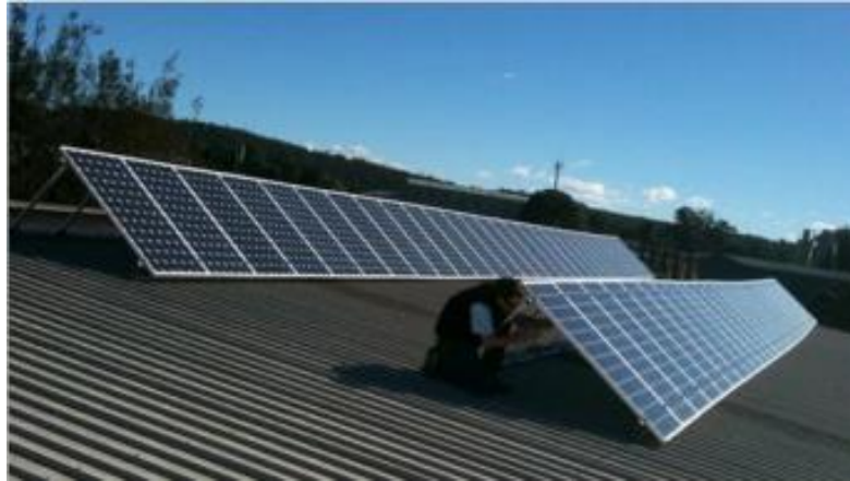
Figura 70: Suporte com correção da inclinação, instalado em telhado metálico
