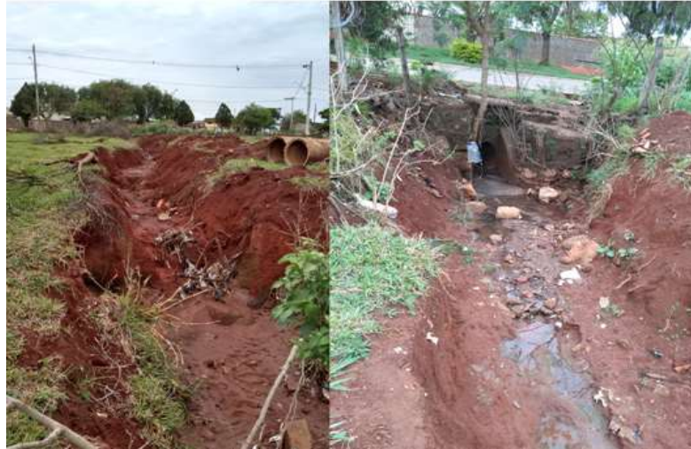
Figura 09 - Local de rompimento da galeria no Jardim Botânico II
