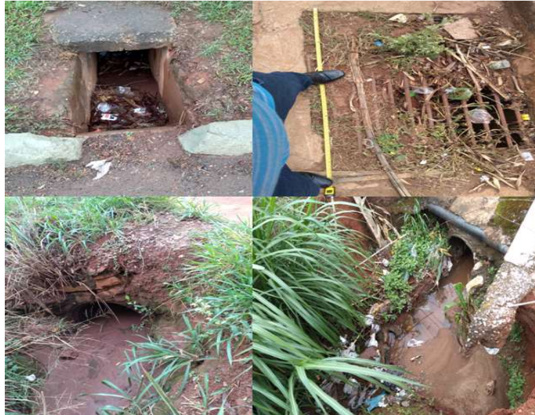
Figura 10 - Acúmulo de resíduos sólidos no sistema de drenagem pluvial
