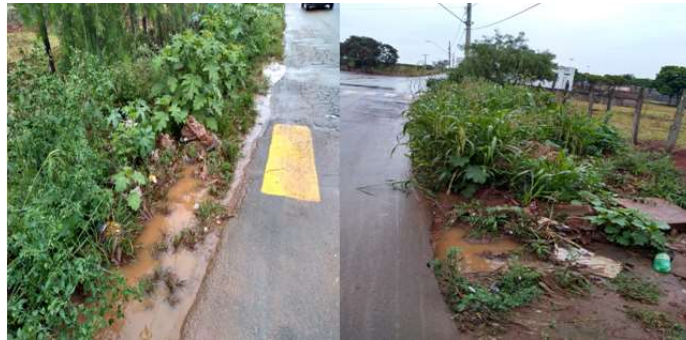
Figura 11 - falta de limpeza da margem direita da LMG-849
