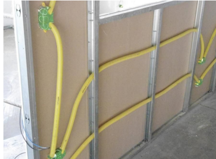
Figura 10: Instalações elétricas no LSF
