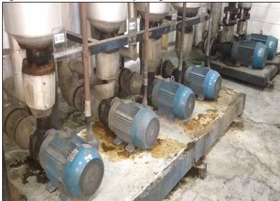
Figura 13 – Motores/bombas de circulação de água dos Chillers
