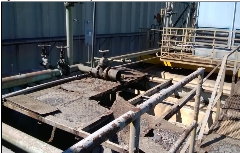
Figura 16 – Estrutura de sustentação da torre do Chiller
