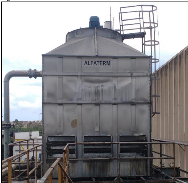
Figura 11 – Torre de resfriamento
