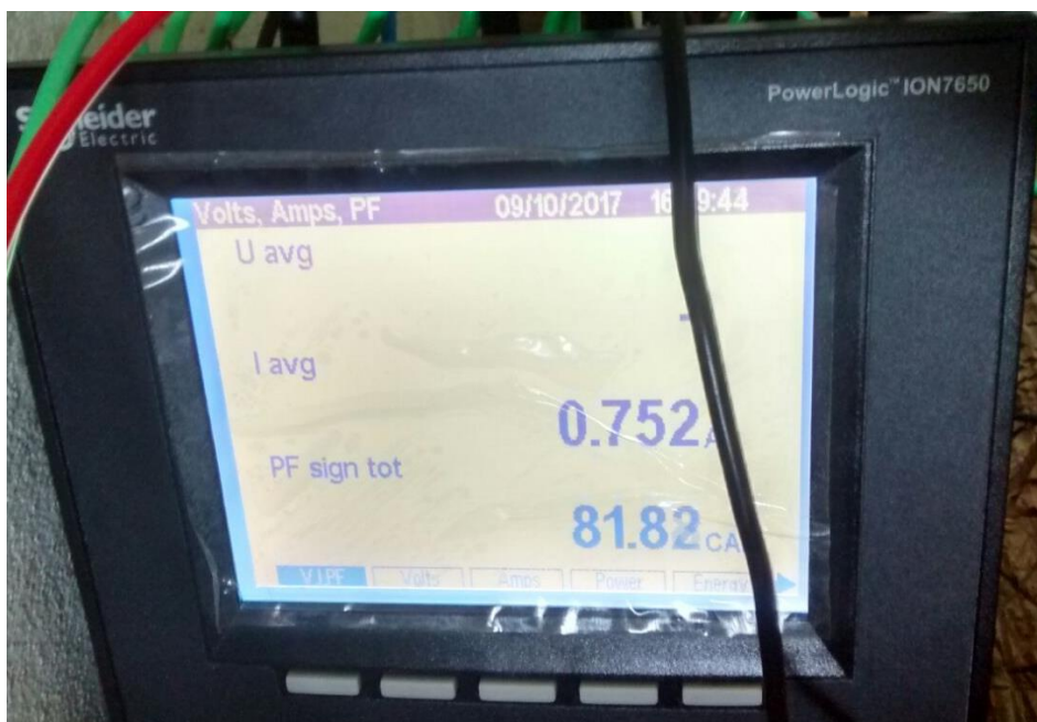
Figura 14 - Analisador PowerLogic® ION7650.
