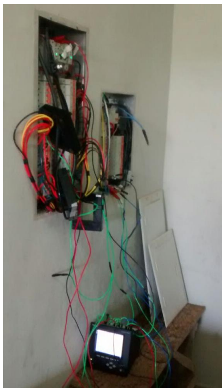
Figura 15 – Instalação do analisador PowerLogic® ION7650.
