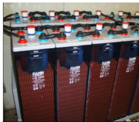
Figura 12 – Banco de Baterias.
