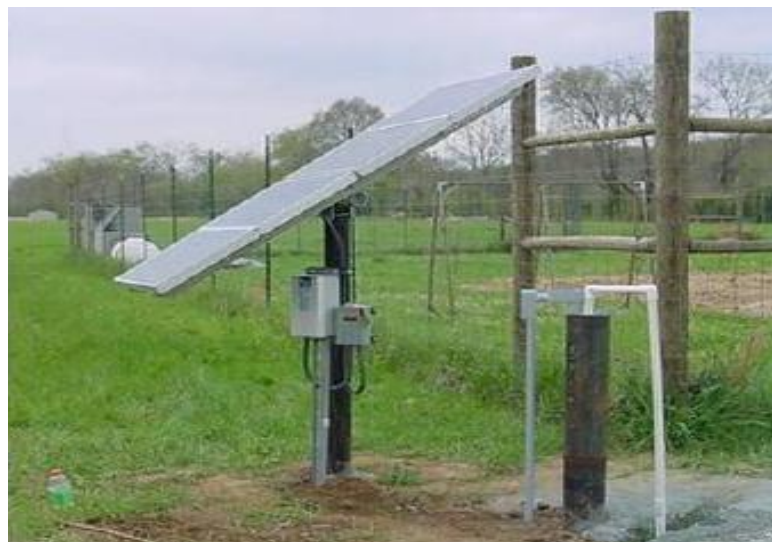
Figura 7 - Sistema de bombeamento fotovoltaico
