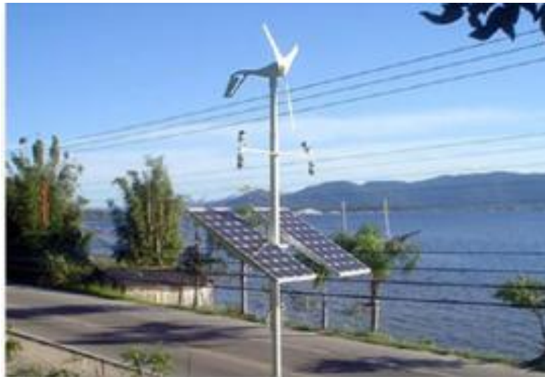
Figura 6 - Sistema hídrico eólico e fotovoltaico
