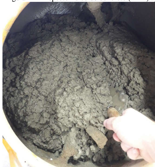
Figura 22 – Aspecto físico do concreto (TR 1) após correções.
