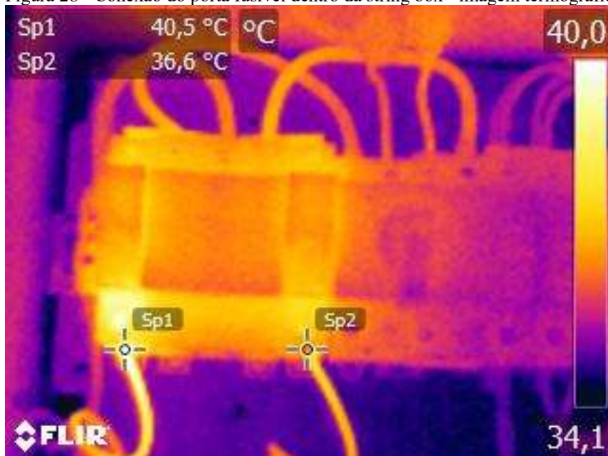
Figura 28 - Conexão do porta fusível dentro da string box - imagem termográfica
