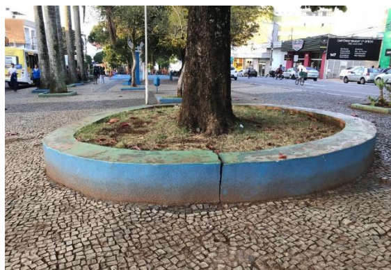
Figura 84: Banco em alvenaria sem manutenção na Pç. Getúlio Vargas.
