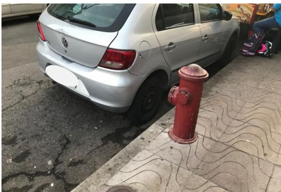
Figura 85: Hidrante instalado na Vila Pinto.
