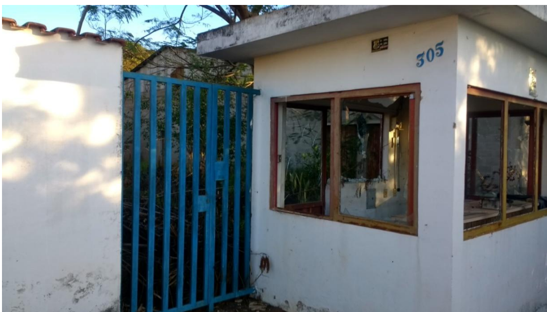
Figura 3 – Vegetação presente na edificação.
