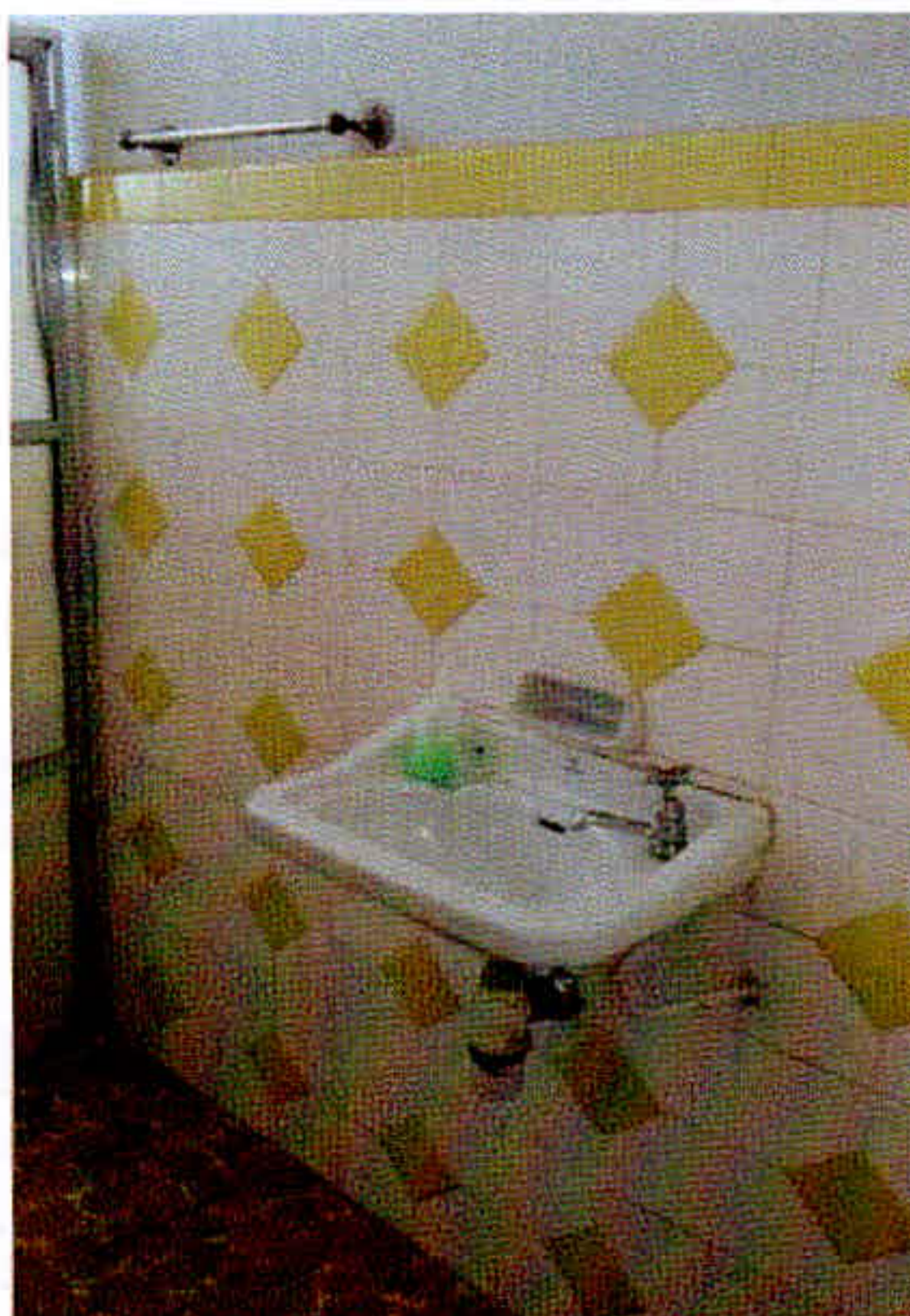
Figura 82 – Lavatório sem barra de apoio. Fonte: a autora, 2015.
