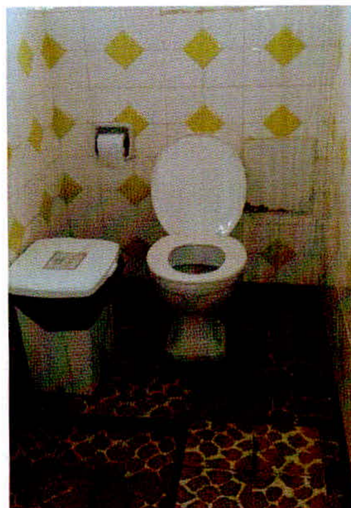
Figura 92 – Papeleira instalada fora do padrão da NBR 9050 (ABNT, 2015). Fonte: a autora, 2015.
