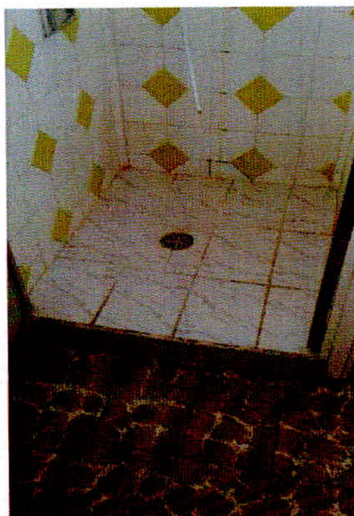
Figura 85 – Degrau no box de chuveiro. Fonte: a autora, 2015.
