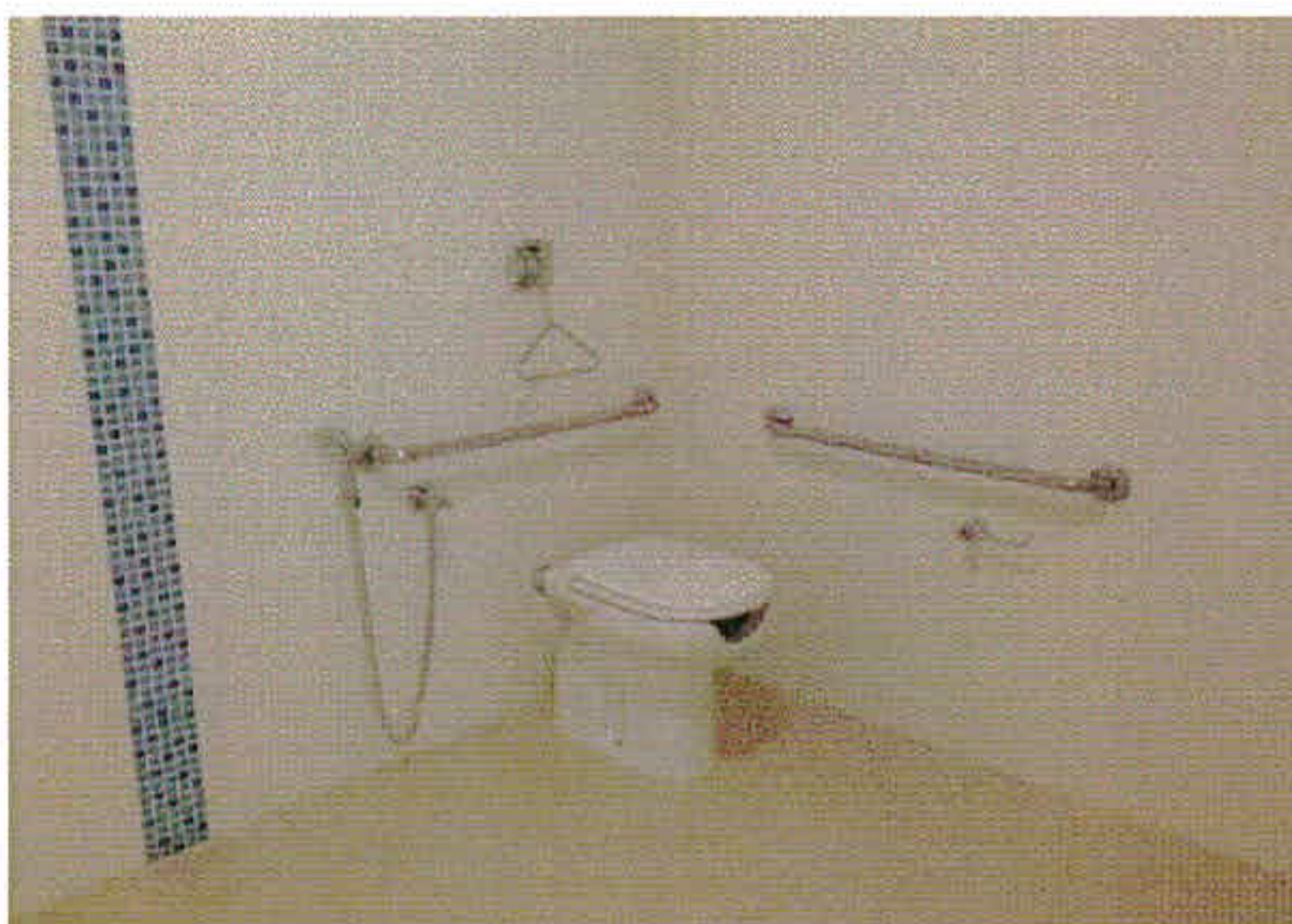
Figura 23 - Bacia sanitária com barras de apoio e válvula de descarga de acordo com a NBR 9050 (ABNT, 2015). Fonte: imagem cedida pelo Hospital Regional Hans Dieter Schmidt.
