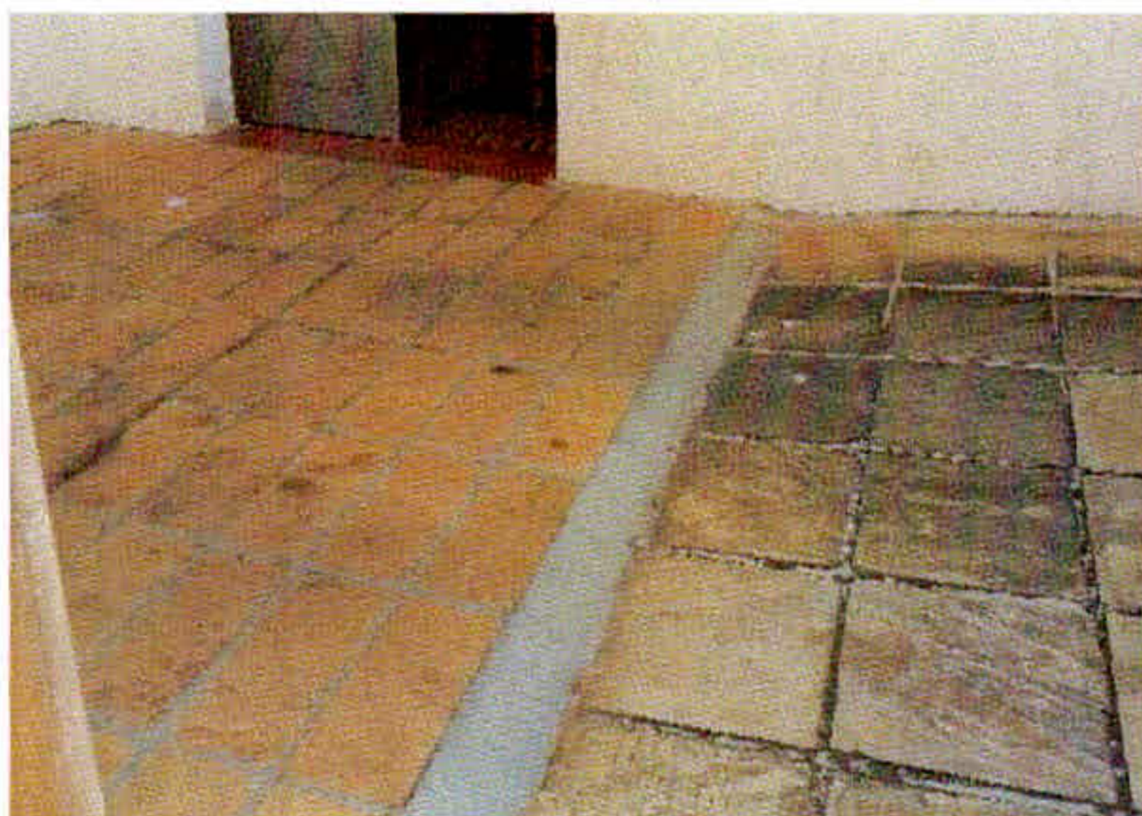
Figura 53 – Desnível na entrada do acesso 2. Fonte: a autora, 2015.
