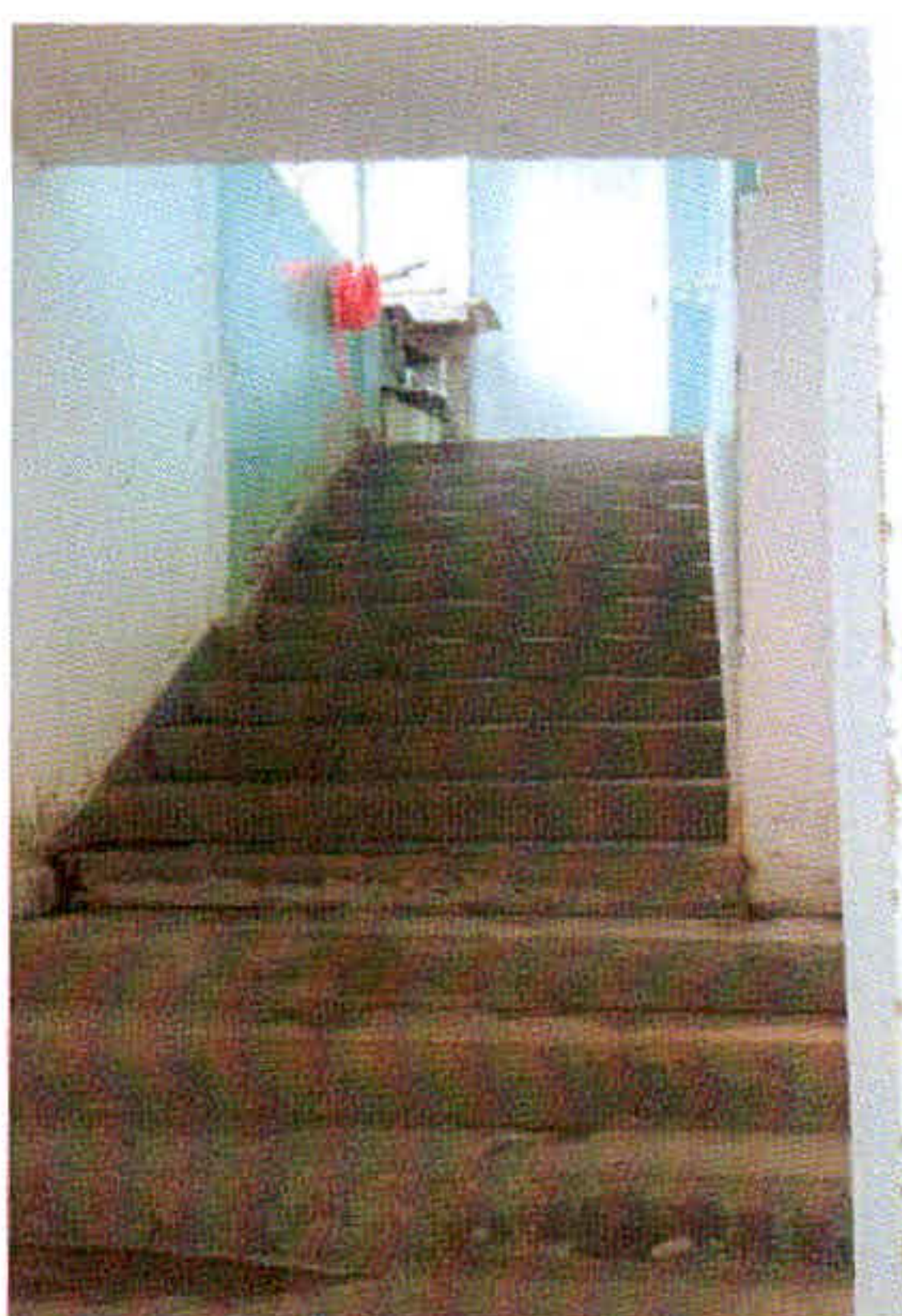
Figura 61 – Escada sem corrimão. Fonte: a autora, 2015.
