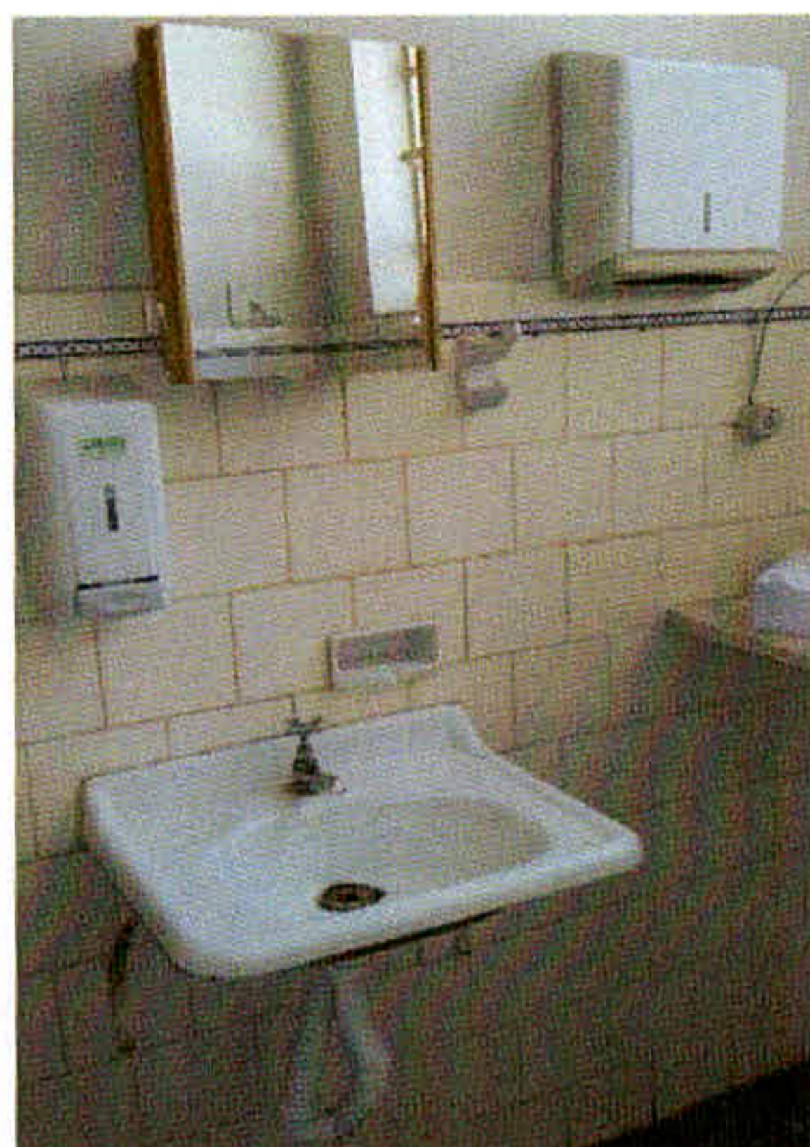
Figura 87 – Acessórios instalados em desacordo com a norma. Fonte: a autora, 2015
