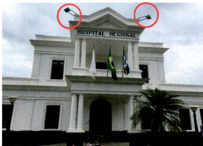
Figura 80. Projetores instalados acima do frontão central. Fonte: a autora, 2015.
