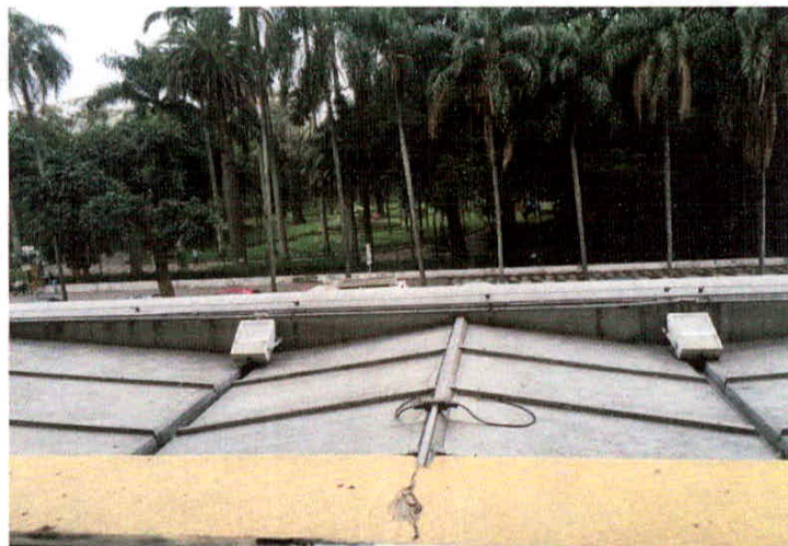
Figura 49. Vista dos projetores instalados na marquise a partir do 2º piso. Fonte: a autora, 2015.
