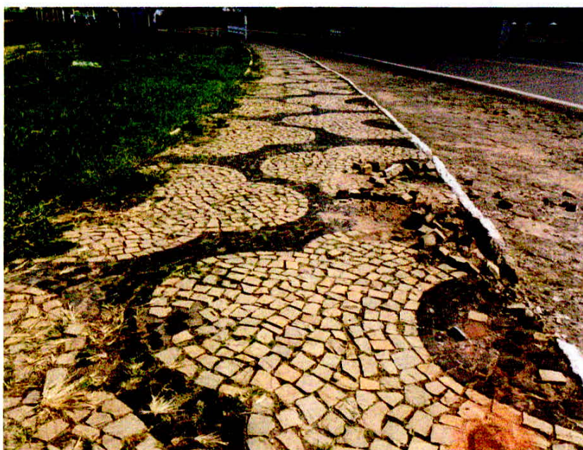
Figura 3- Calçada no percurso de caminhada do lago, em deterioração;
