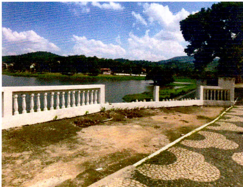
Figura 4- Guarda-corpo, destruído pela população;
