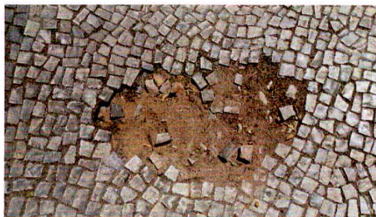
Figura 72 – Pavimentação quebrada – Praça José Rezende de Paiva.
