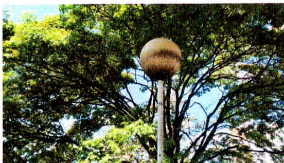
Figura 76 – Poste de iluminação sujo – iluminação indireta
