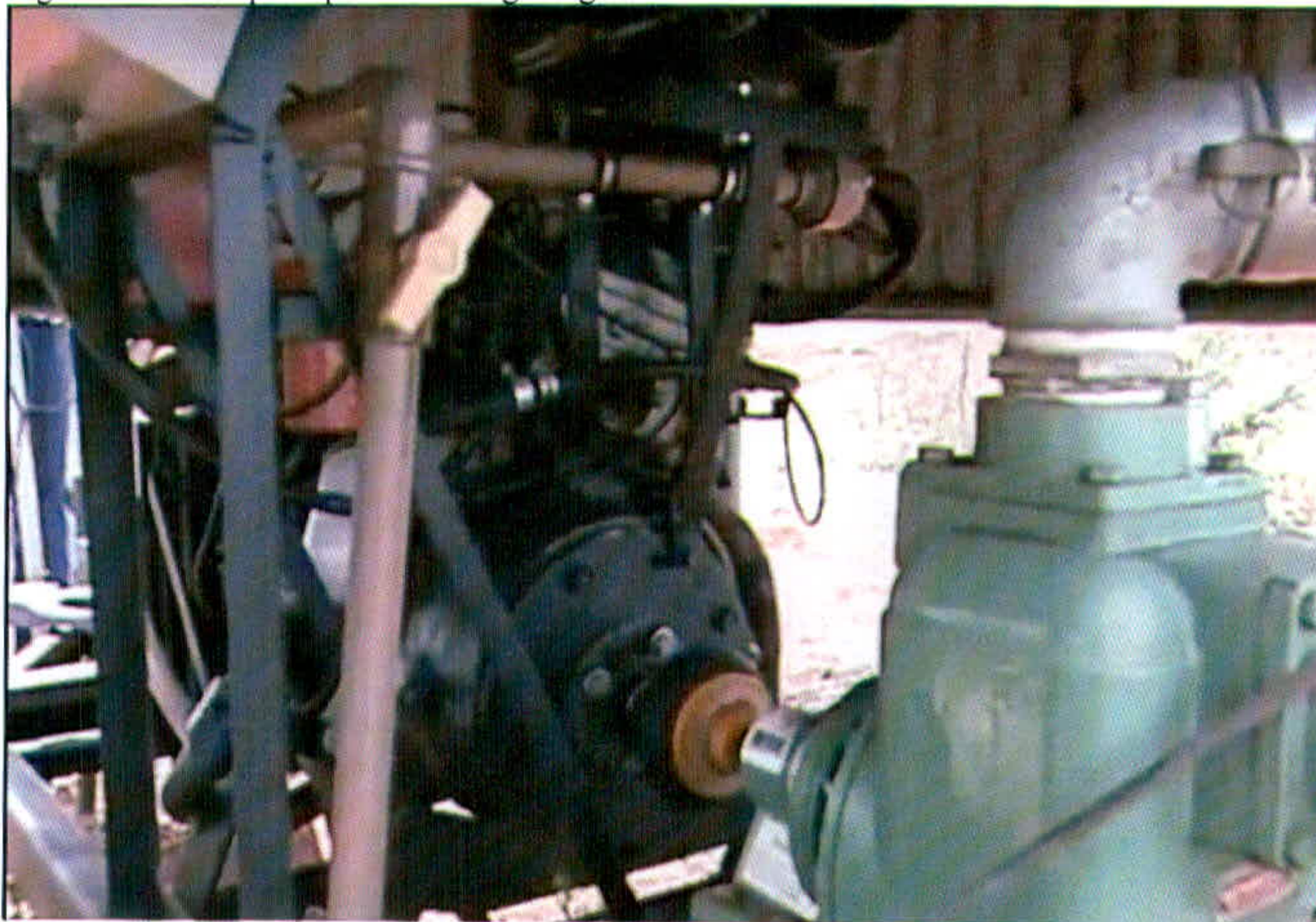
Figura 15: Motor para queimar o biogás e gerar eletricidade
