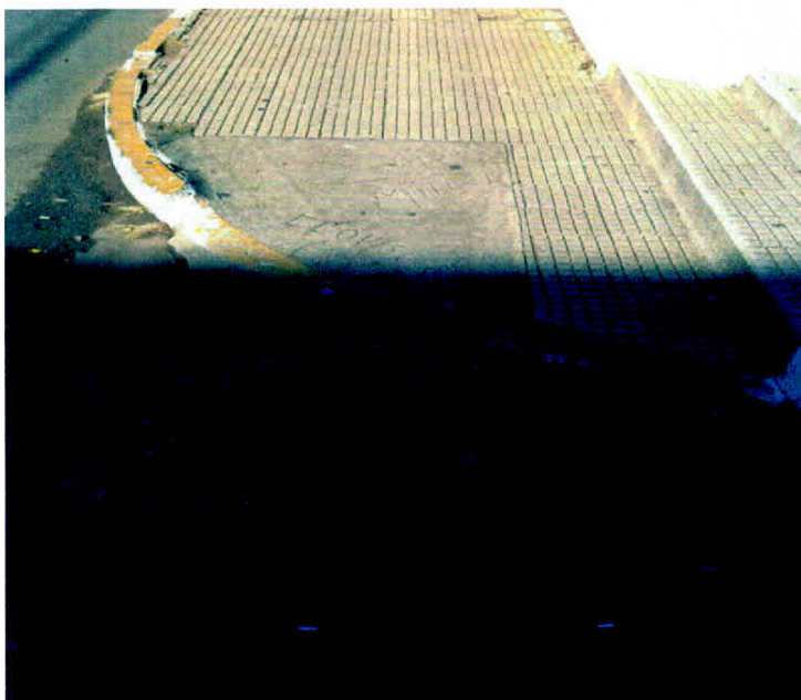
Figura 19: Rebaixamento de guia inadequado.
