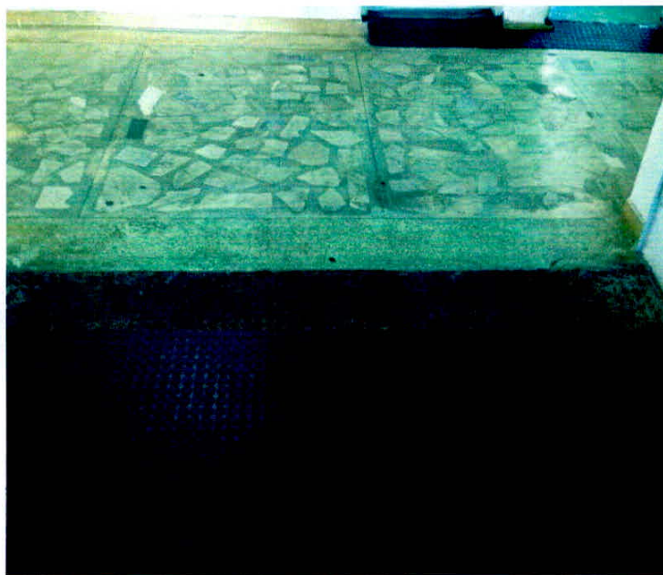
Figura 23: Piso irregular na parte interna da prefeitura
