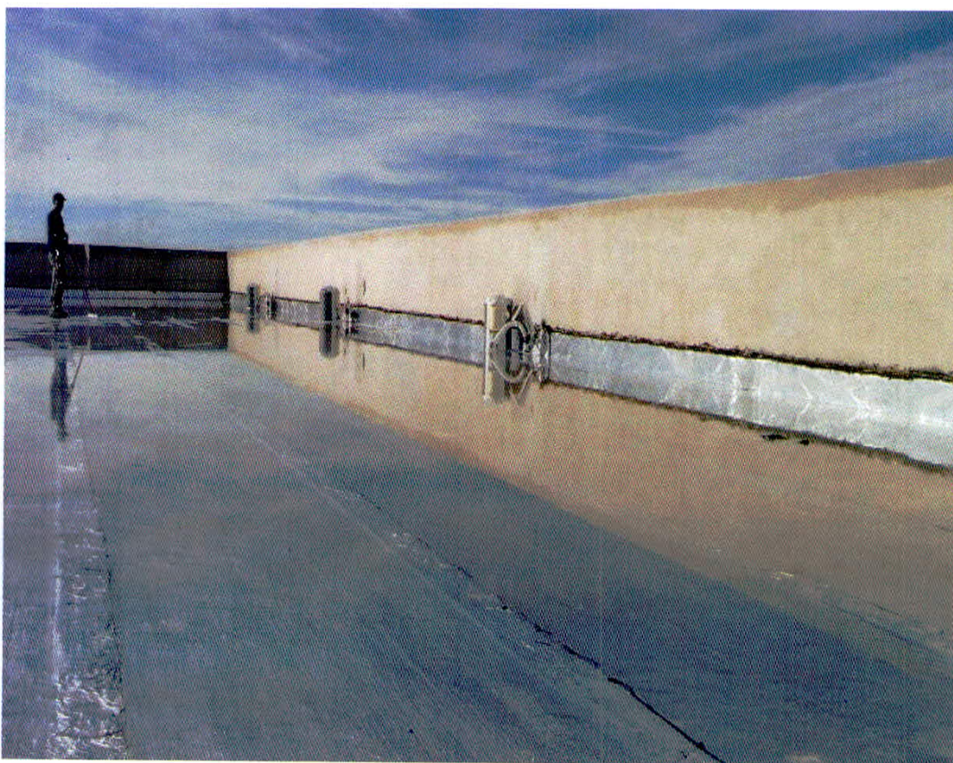
Figura 24 – Teste de Estanqueidade
