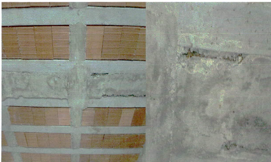
Figura 6 – Oxidação da Armadura
