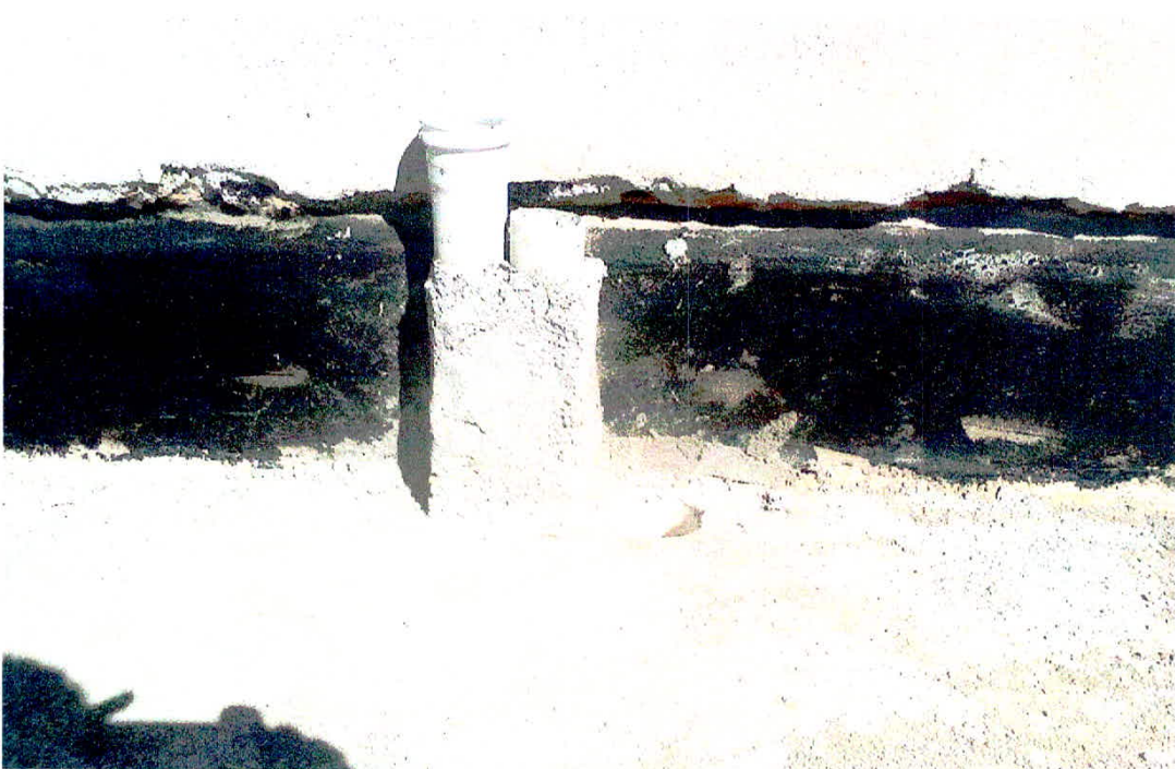
Figura 15 – Coletores de Águas Pluviais e Sistema Hidráulico
