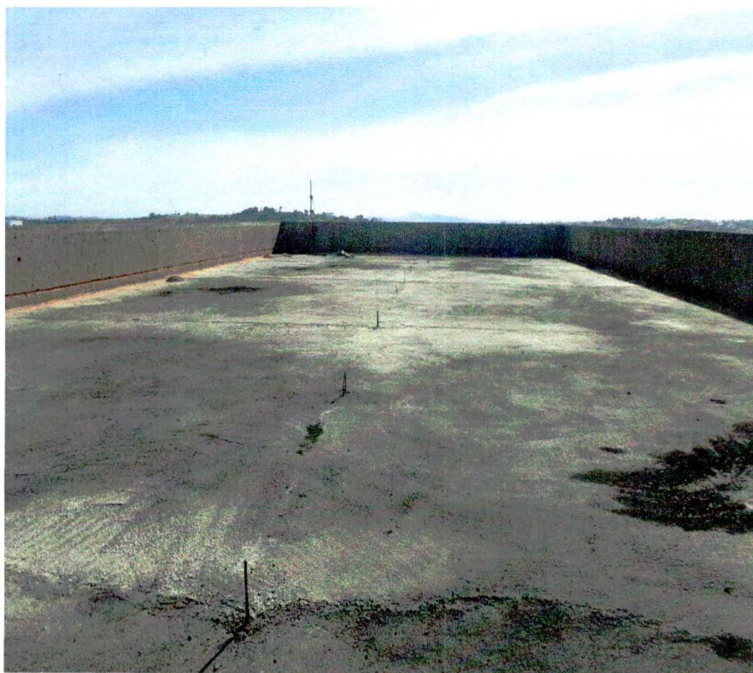
Figura 9 – Laje em Concreto Usinado sem Caimentos
