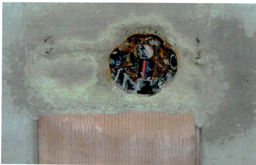
Figura 7 – Oxidação das Caixas de Luz
