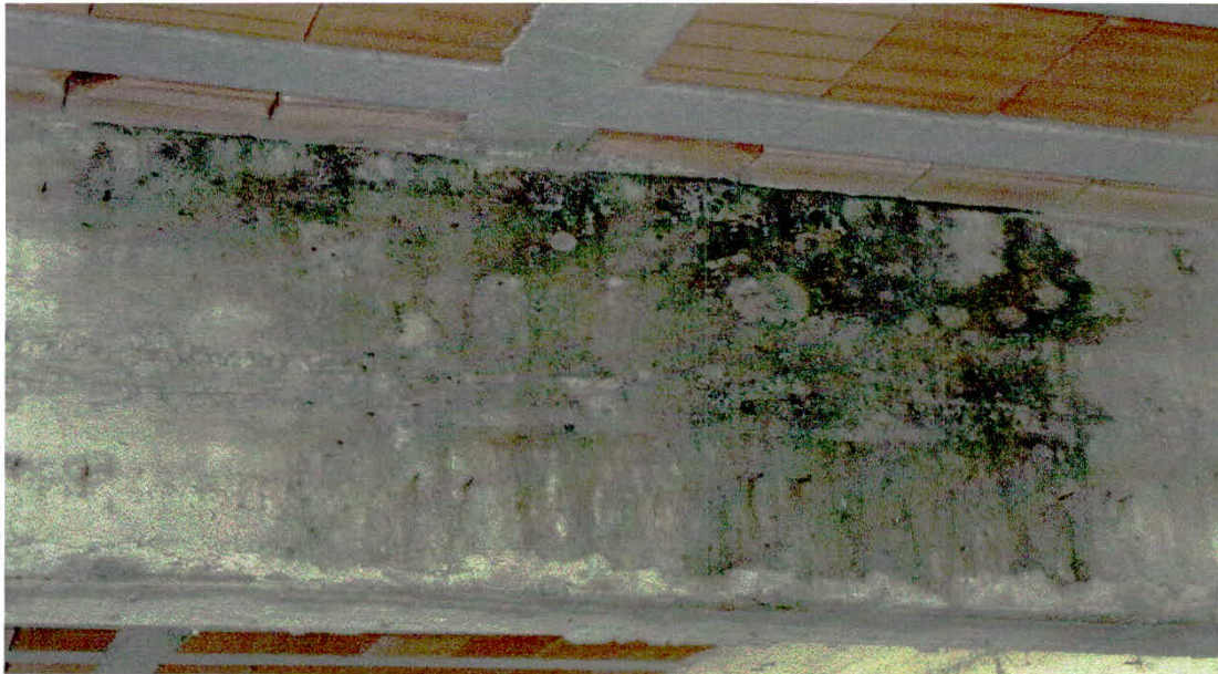
Figura 4 - Manchas e Goteiras
