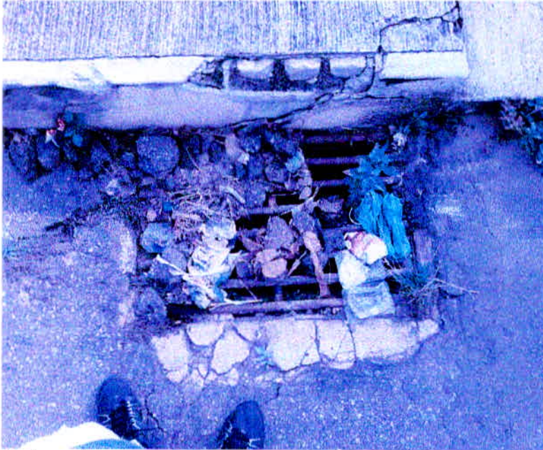
Figura 24 – Boca de lobo com sujeira
