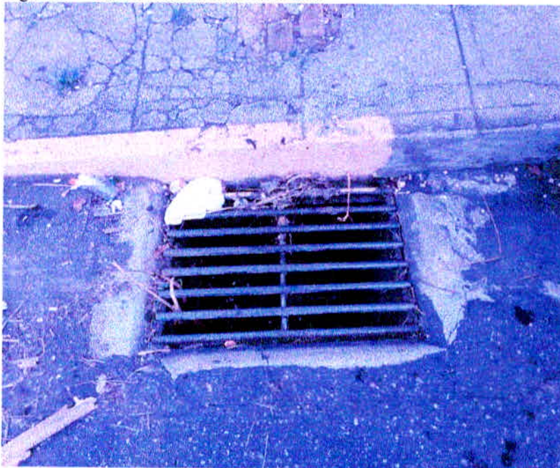
Figura 23 – Boca de lobo na Rua Dona Zica
