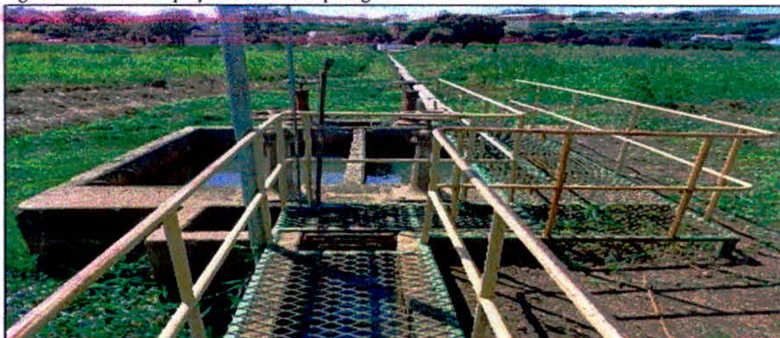
Figura 06: Ponto de Captação devidamente protegido
