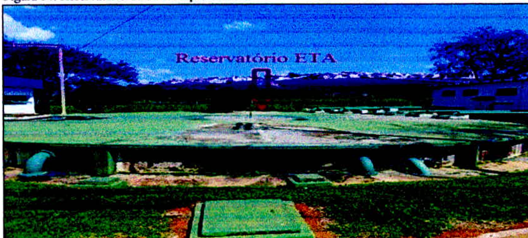
Figura 14: Reservatório de distribuição da ETA
