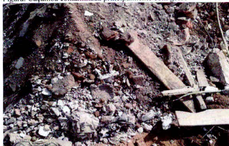
Figura: Caçamba contaminada principalmente com gesso
