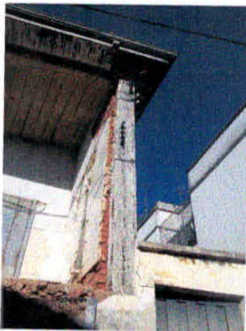
Figura 8 – Fendas na base inferior do Pilar 5.
