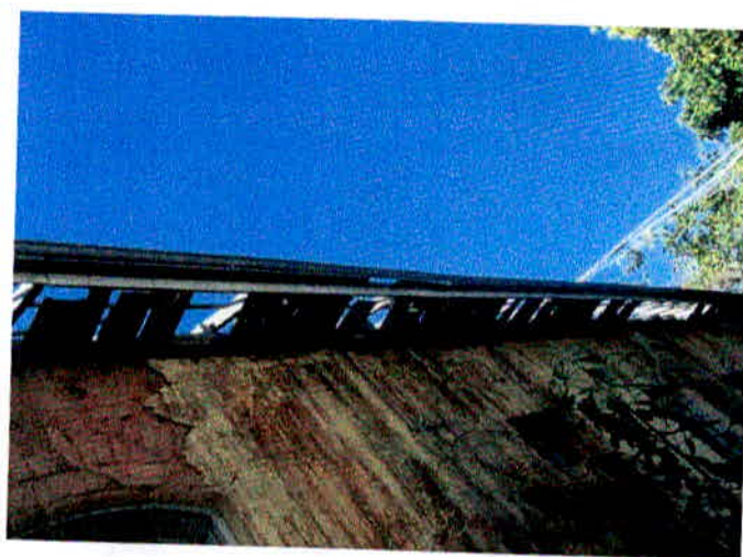
Figura 18 – Calhas em alumínio.
