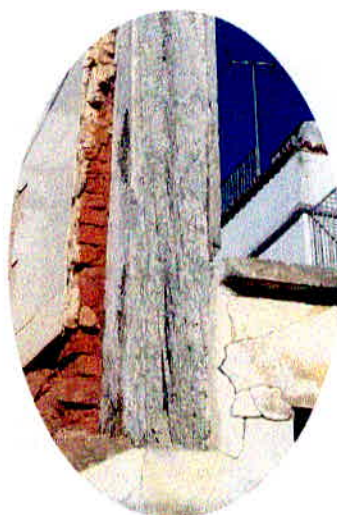
Figura 3 – Fendas na parede e no pilar.
