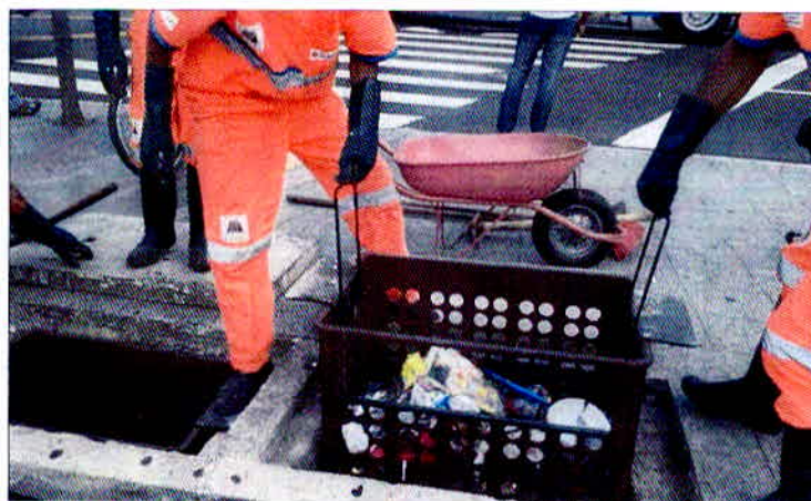
Figura 13 : Cestas acopladas às bocas de lobo Fonte: SWU - Bueiros sustentáveis são testados em São Paulo (2012)
