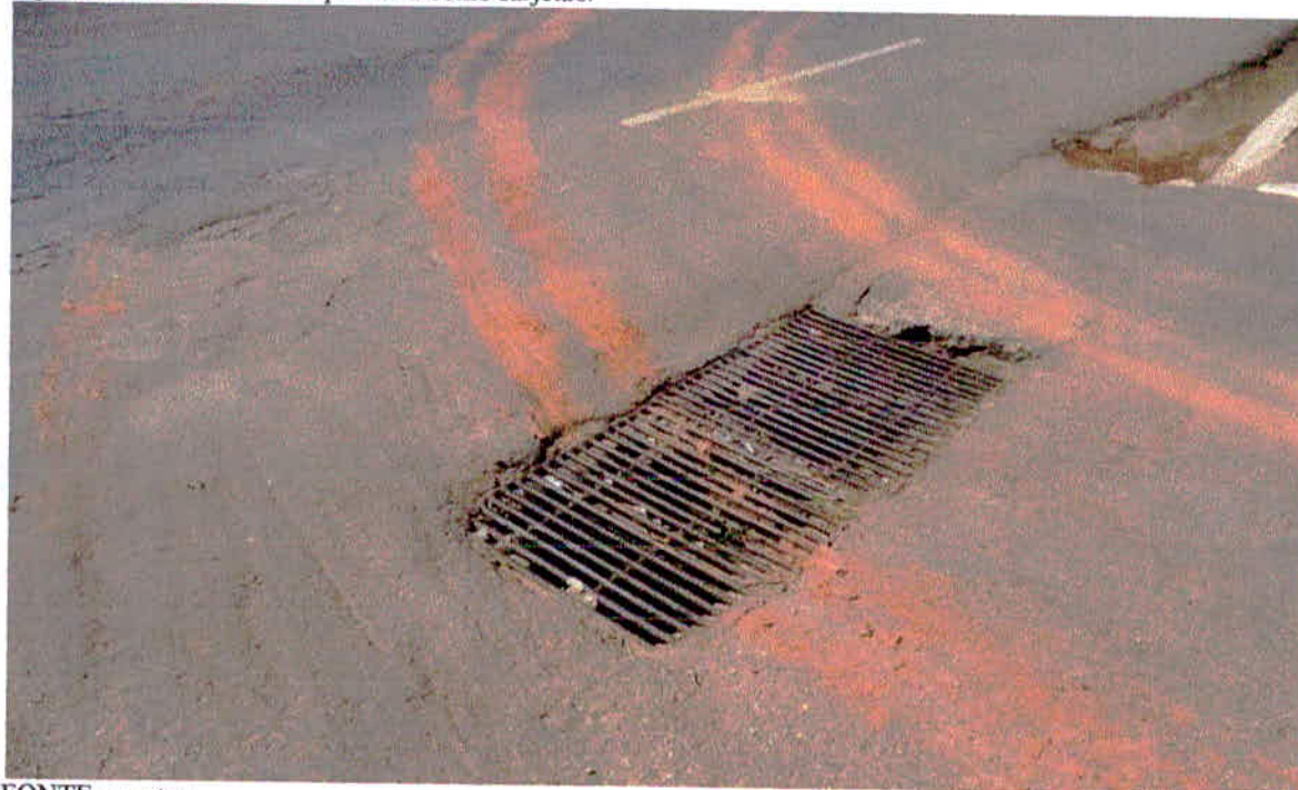
Figura 11: Boca de lobo implantada como sarjetão.
