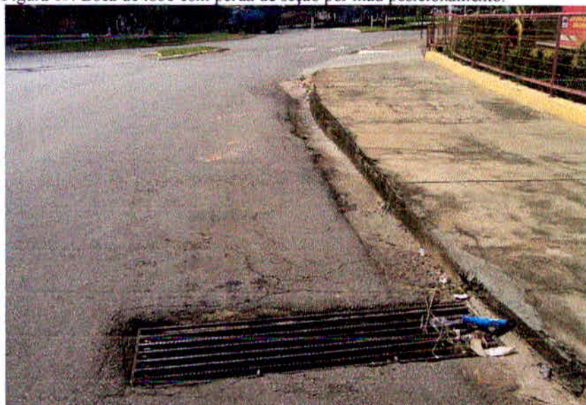
Figura 09: Boca de lobo com perda de seção por mau posicionamento.
