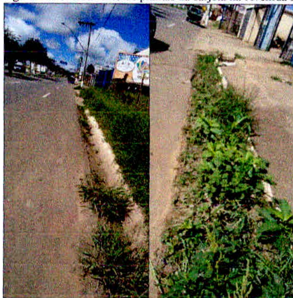
Figura 07: Crescimento de plantas na sarjeta na Avenida Deputado Renato Azeredo.
