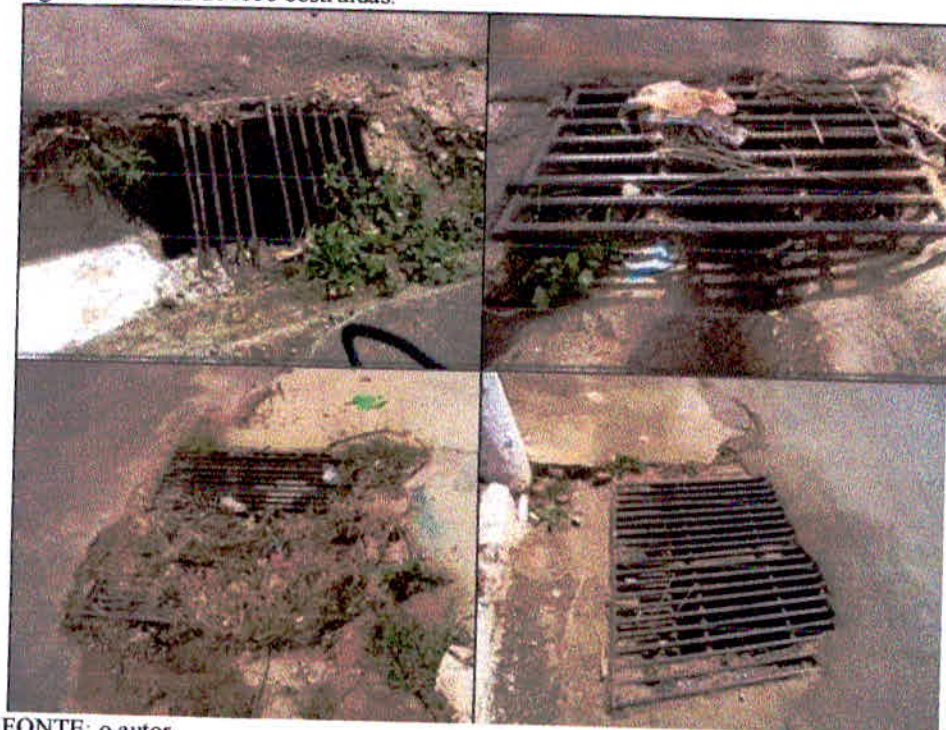
Figura 13: Bocas de lobo obstruídas.
