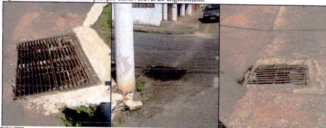
Figura 10: Bocas de lobo com posição desfavorável ao engolimento.
