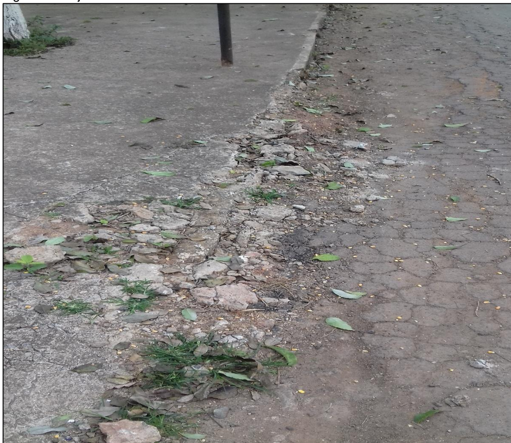
Figura 4- Sarjeta danificada na rua Francisco Vieira Dias
