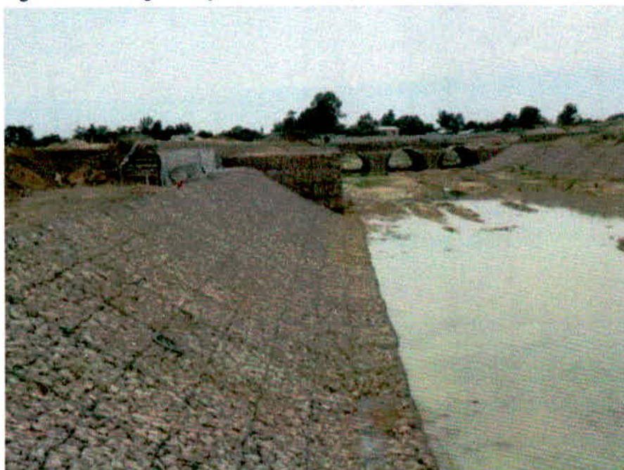
Figura 8 - Foto de gabião tipo colchão de reno, utilizado em canal
