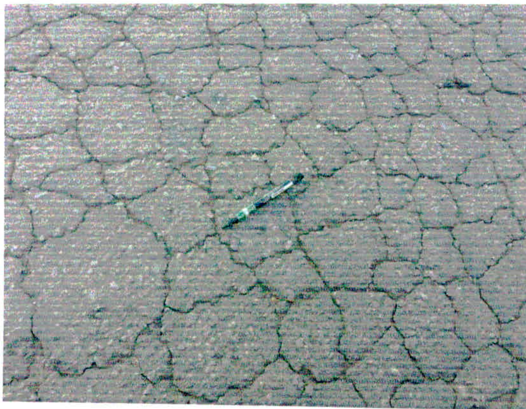
Figura 2 – Trincamento tipo crocodilo ou jacaré.
