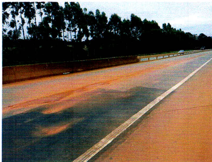
Figura 39 – Bombeamento de finos através das trincas
