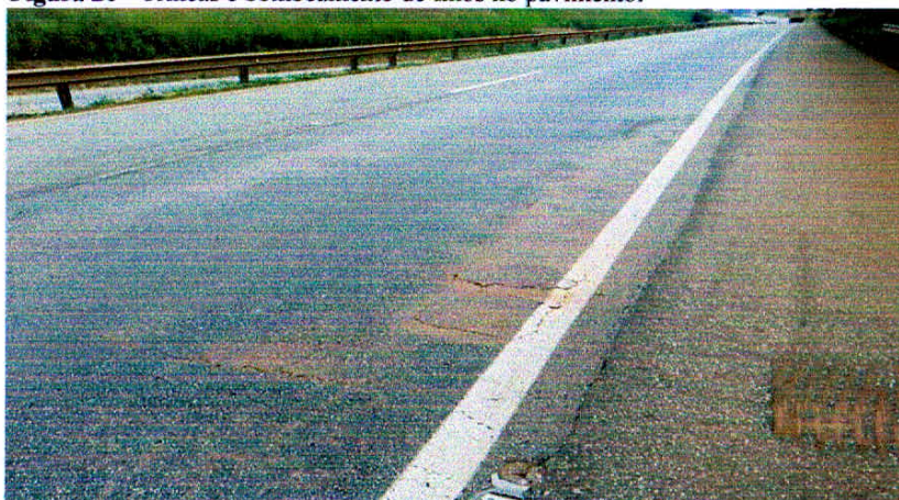
Figura 20 - Trincas e bombeamento de finos no pavimento.
