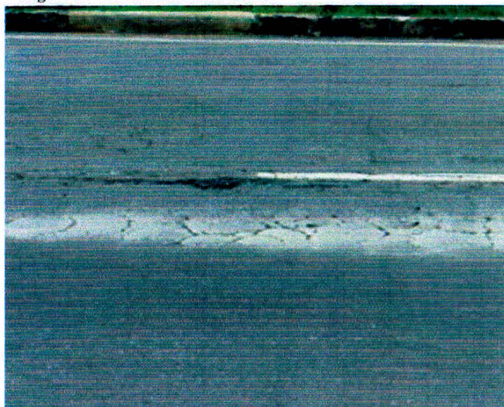
Figura 19 - Bombeamento de finos.
