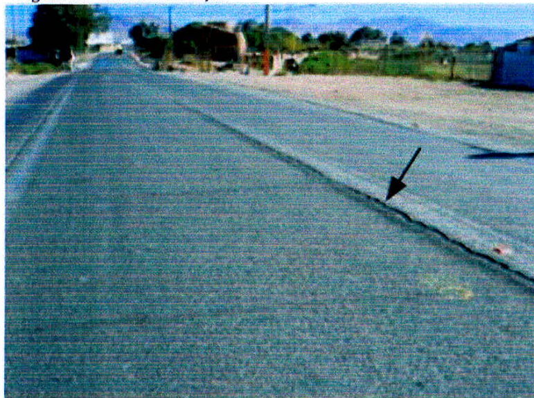
Figura 18 - Trinca de Retração.
