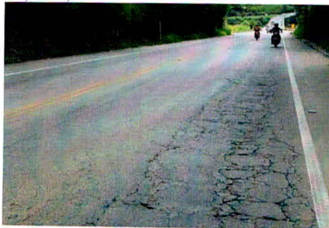
Figura 27– Trinca “Tipo Bloco” com Erosão, no segmento km 254,3 a 254,8
