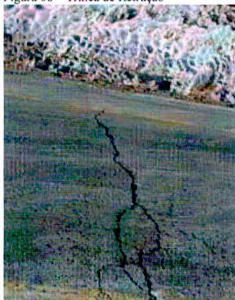
Figura 08 – Trinca de Retração
