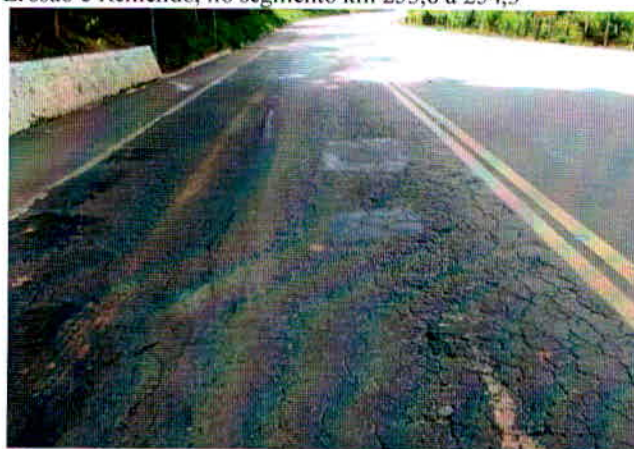
Figura 26 – Trecho com Trinca “Couro de Jacaré” com Erosão e Remendo, no segmento km 253,8 a 254,3
