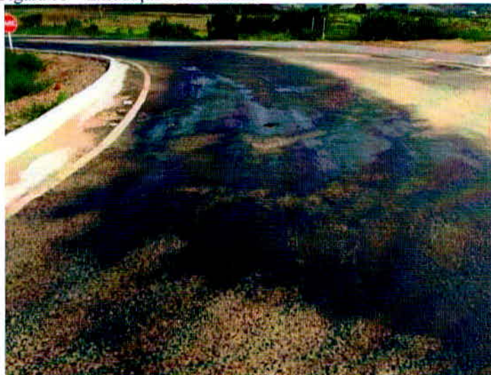
Figura 16 – Exsudação do Pavimento
