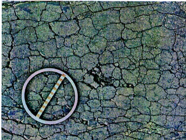
Figura 09 – Trinca tipo “Couro de Jacaré” com erosão
