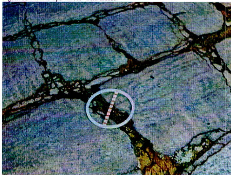
Figura 11 - Trinca tipo "Bloco" com erosão
