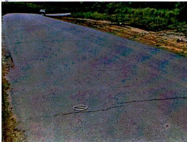
Figura 06 – Trinca Isolada Transversal
