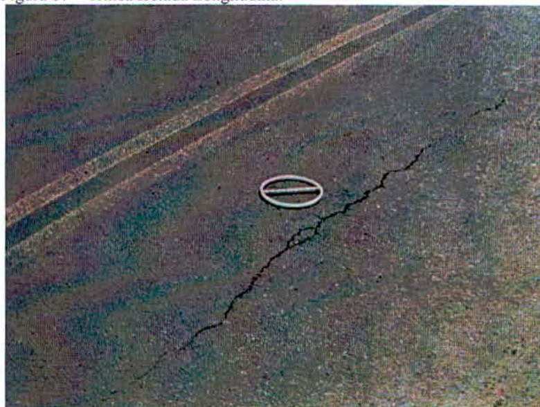
Figura 07 – Trinca Isolada Longitudinal
