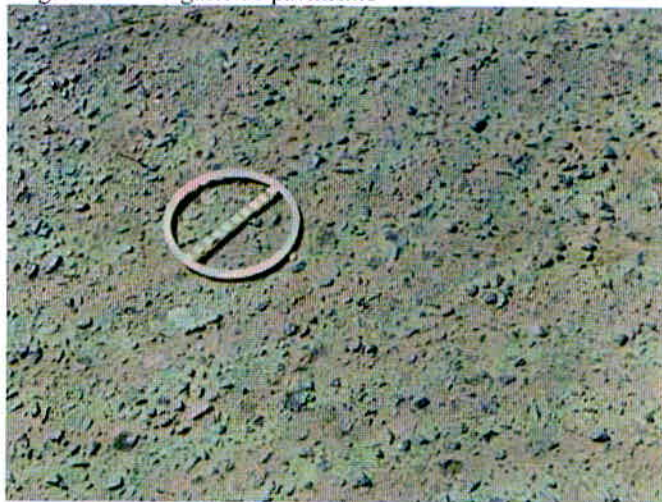
Figura 17 – Desgaste do pavimento
