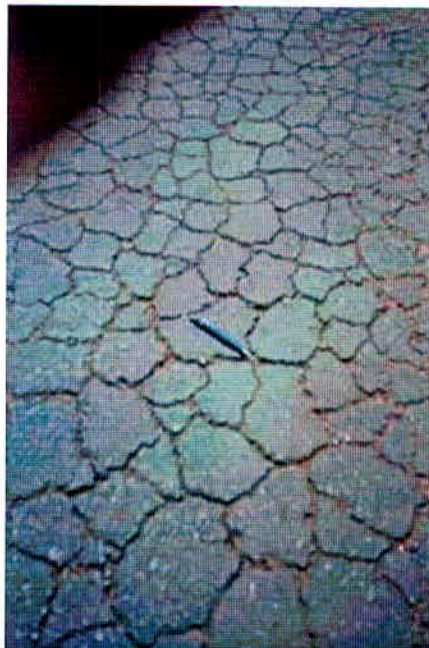
Figura 10 - Trinca tipo “Couro de Jacaré” sem erosão
