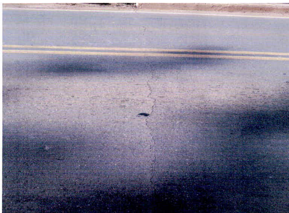
Figura 52 – Foto 22 Vista Superior – Junta danificada ou Inexistente
