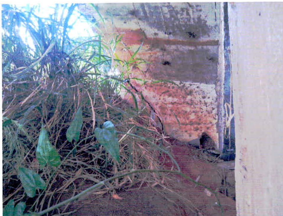
Figura 54 – Foto 21 Vista Inferior – Cortina de Concreto Armado – Região com Concreto Rompido
