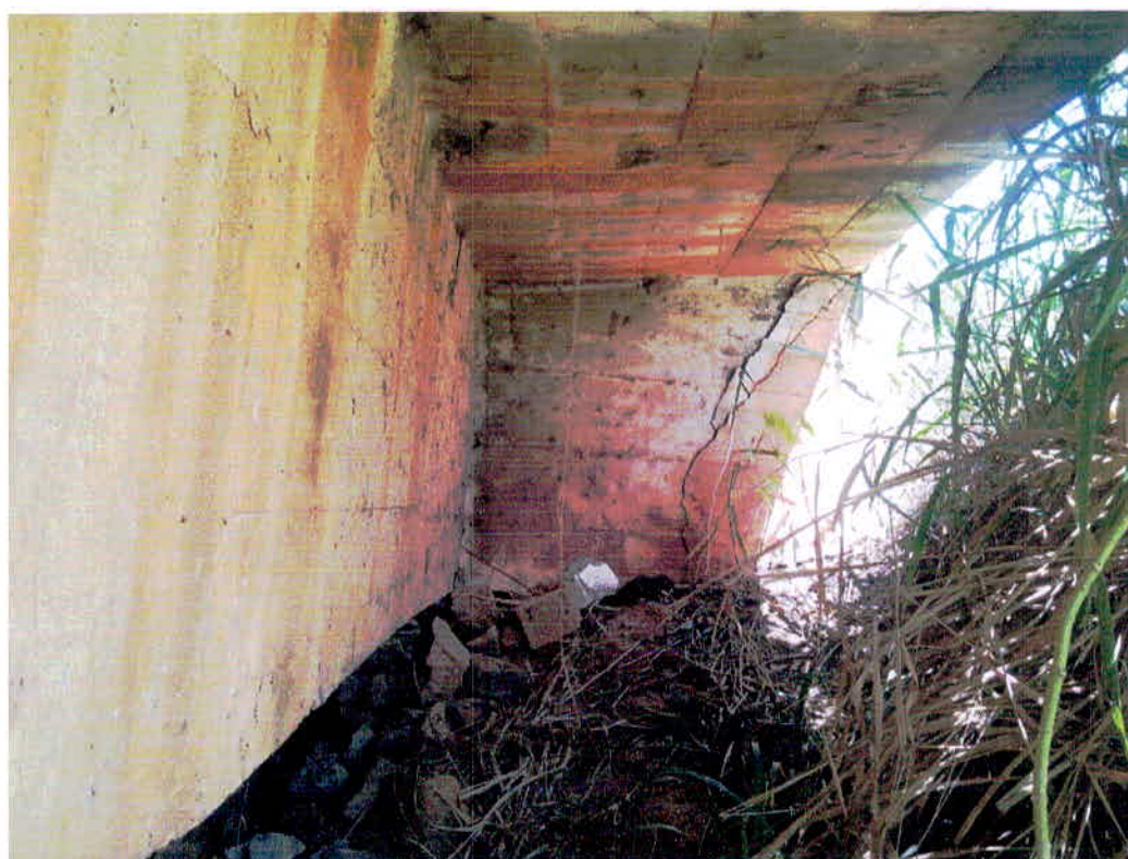
Figura 55 – Foto 26 Vista Inferior – Cortina de Concreto Armado – Região com Concreto Rompido
