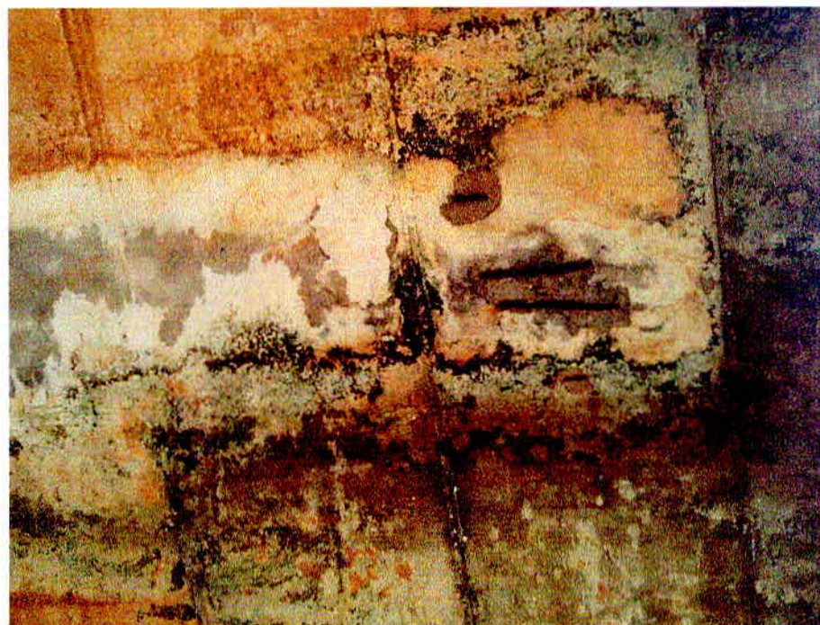
Figura 65 – Foto 25 Vista Inferior – Concreto Desagregado com Armadura Exposta Oxidada / Lixiviação e Mancha de Carbonatação
