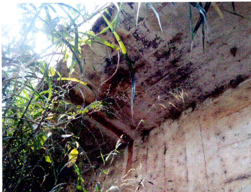
Figura 60 – Foto 20 Vista Inferior – Laje de Concreto Armado- Lixiviação e Mancha de Carbonatação / Infiltração no Concreto / Dreno Danificado
