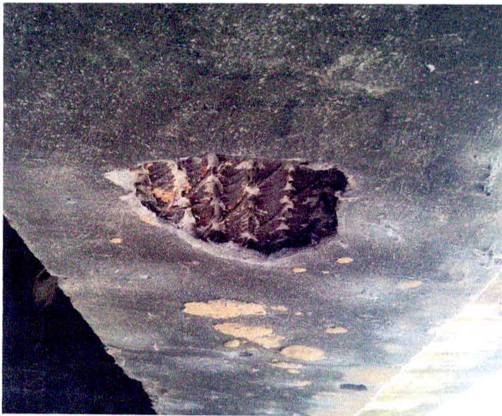
Figura 56 – Foto 23 Vista Inferior – Viga de Concreto Armado – Deslocamento de Concreto com Armadura Exposta (Nicho de Concretagem)
