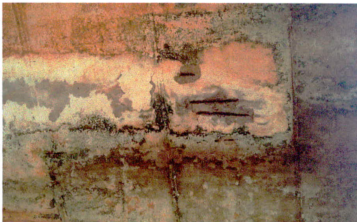
Figura 64 – Foto 24 Vista Inferior – Concreto Desagregado com Armadura Exposta Oxidada / Infiltração no Concreto
