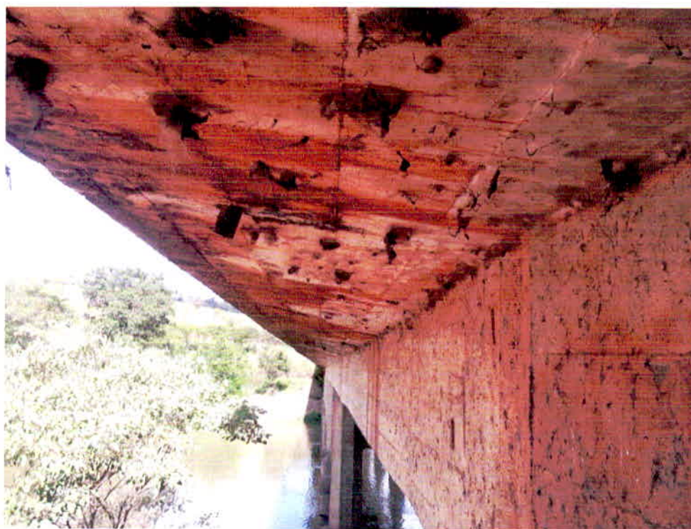
Figura 57 – Foto 12 Vista Inferior Laje de Concreto Armado - Lixiviação e Mancha de Carbonatação / Infiltração no Concreto
