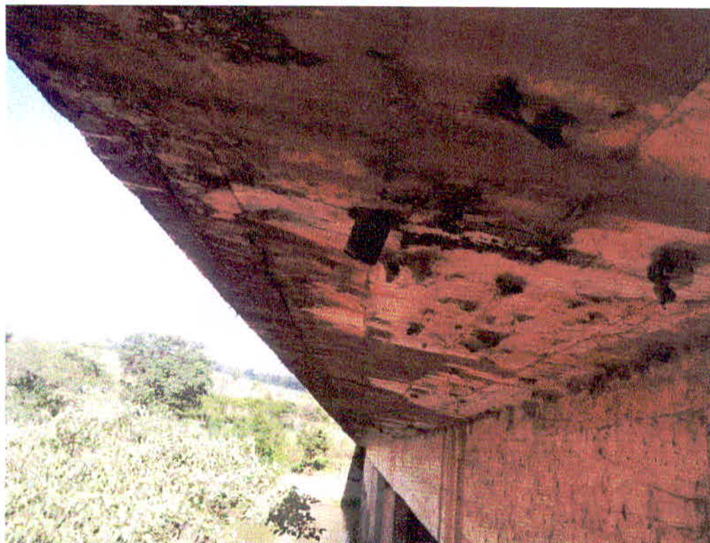
Figura 58 – Foto 14 Vista Inferior Laje de Concreto Armado – Lixiviação e Mancha de Carbonatação / Infiltração no Concreto
