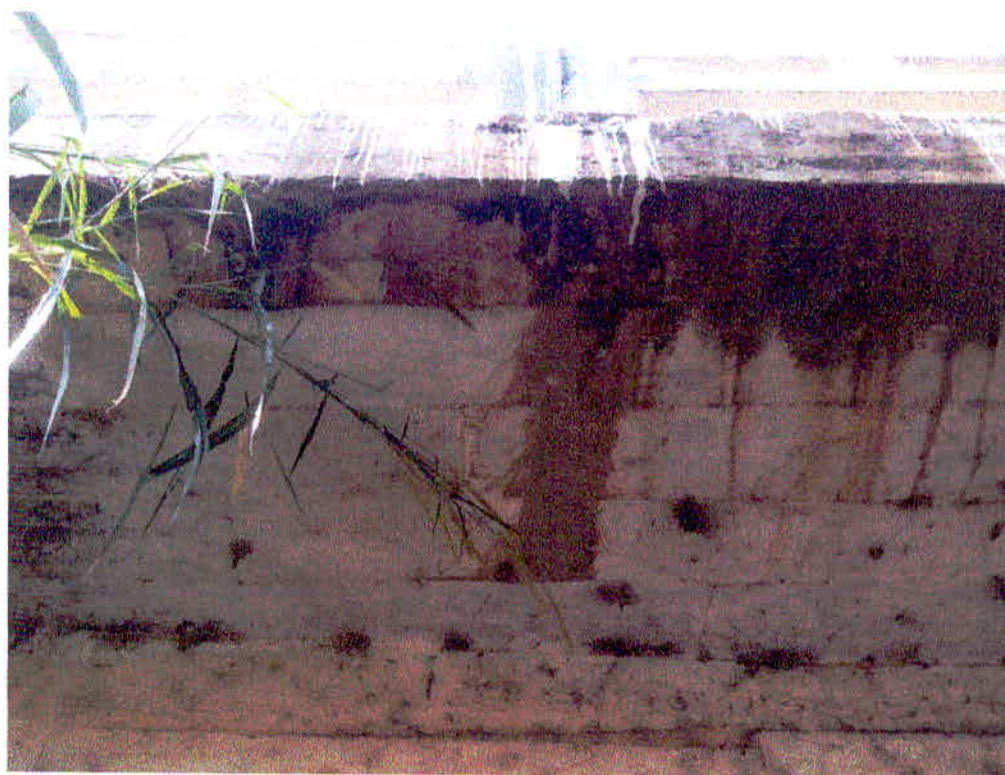
Figura 59 – Foto 19 Vista Inferior – Laje de Concreto Armado- Lixiviação e Mancha de Carbonatação / Infiltração no Concreto
