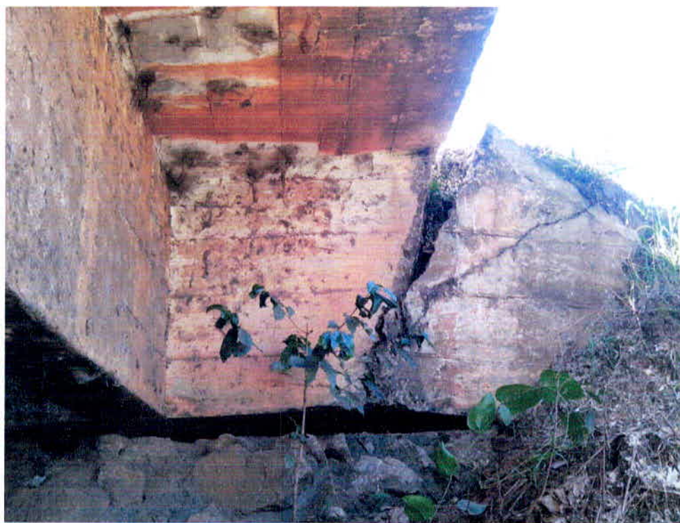
Figura 53 – Foto 17 Vista Inferior – Cortina de Concreto Armado – Região com Concreto Rompido
