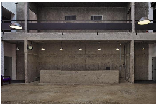
Figura 55 - Concreto queimado no Teatro Erotides
