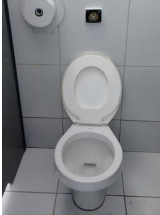
Figura 15 - Bacia sanitária com válvula de descarga
