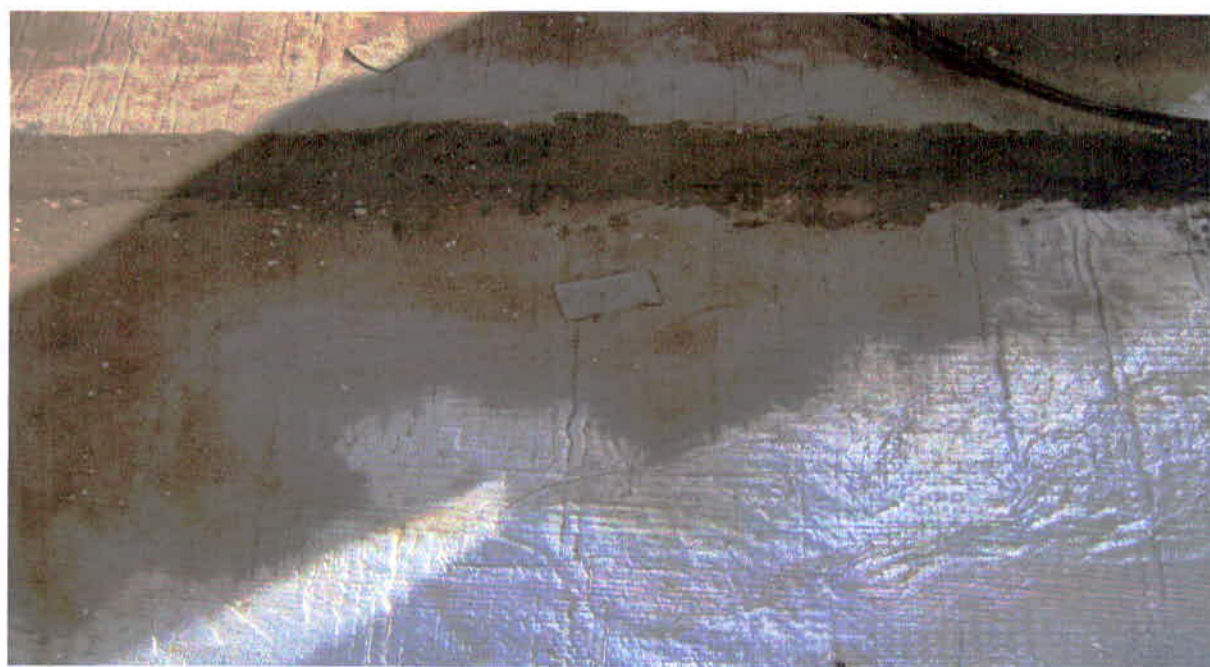
Figura 27– Detalhe em emendas tapando buracos feitos pelo usuário da residência.
