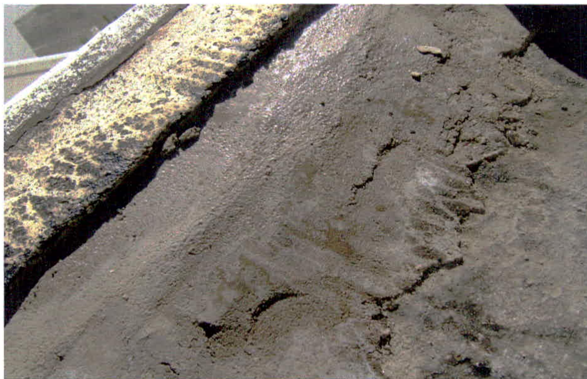
Figura 26 – Após a retirada da manta observou-se a formação de gotículas de água.
