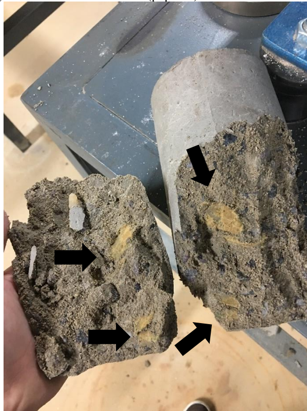
Figura 25 - Material deletério (papelão) na amostra de concreto.
