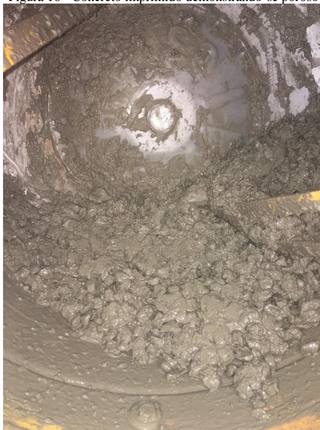
Figura 16 - Concreto imprimido demonstrando-se poroso
