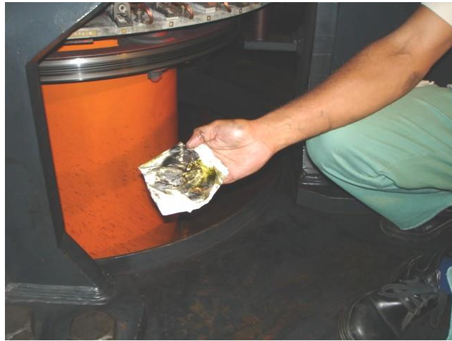
Figura 3: Identificação de óleo no gerador
