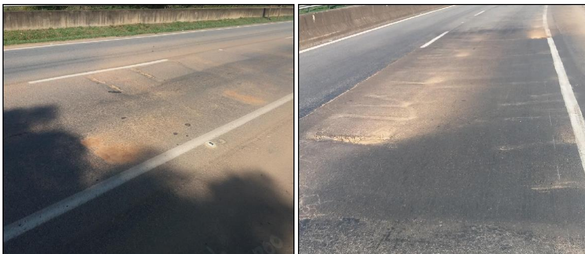
Figura 2 e 3 – Bombeamento de Finos
