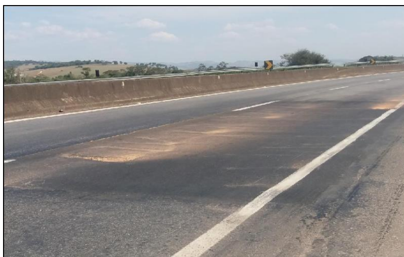
Figura 4 – Bombeamento de Finos
