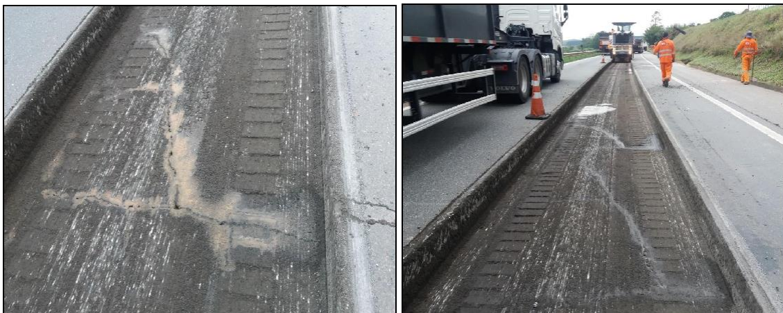
Figuras 9 e 10 - Fresagem Estrutural de 10cm - Base Trincada e com Bombeamento de Finos
