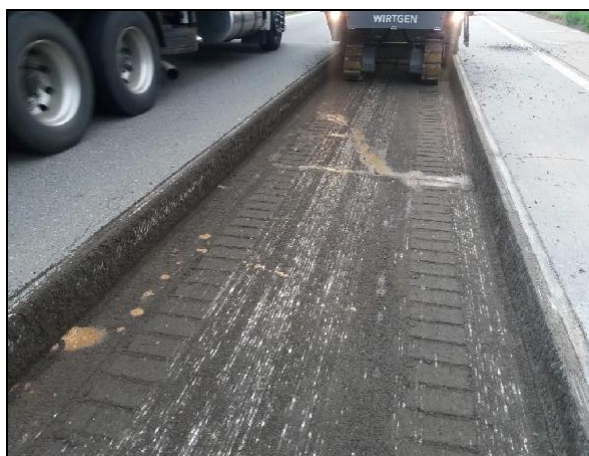
Figura 11 - Fresagem Estrutural de 10cm - Base Trincada e com Bombeamento de Finos
