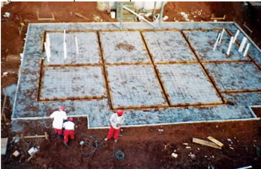
Figura 44 - Radier ultrapassa o limite das paredes.
