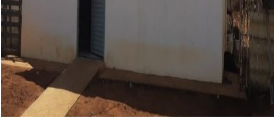
Figura 11 - Umidade no rodapé da edificação
