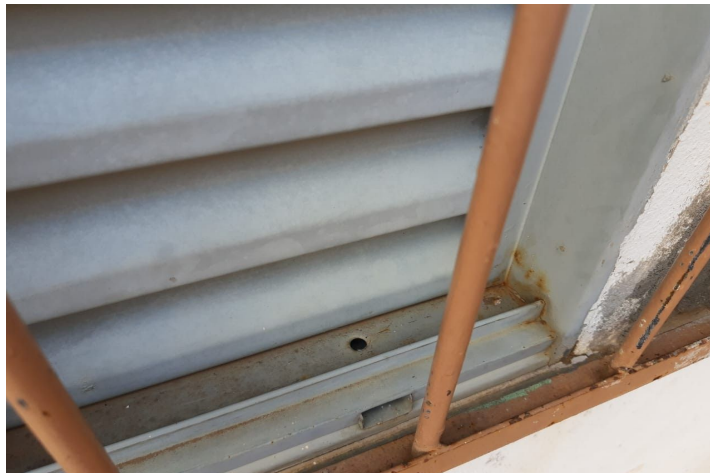
Figura 09 - Corrosão na esquadria
