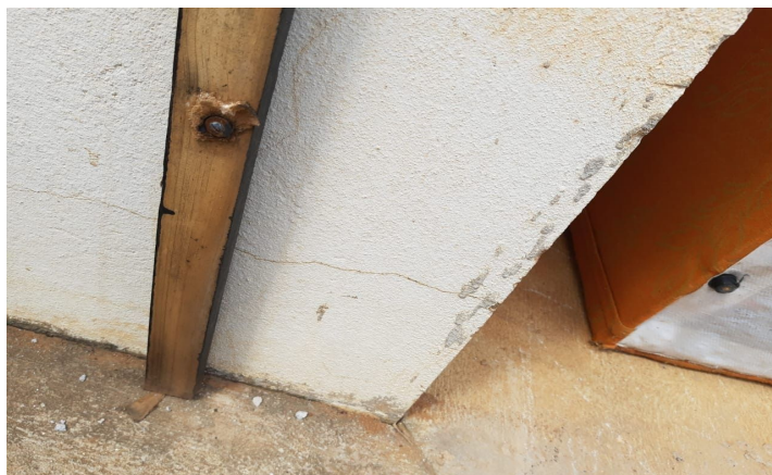
Figura 10 - Fissura na Alvenaria
