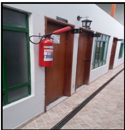
Figura 2- Extintor de Incêndio H2O
