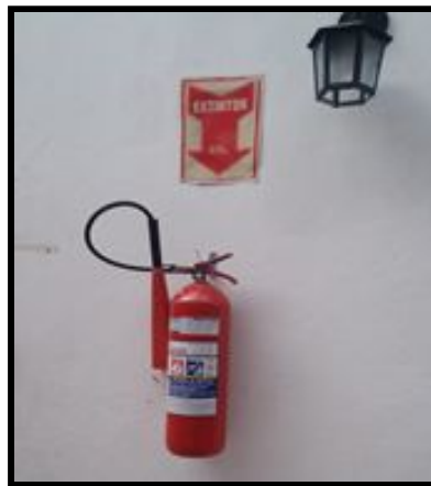
Figura 3- Extintor de Incêndio CO2
