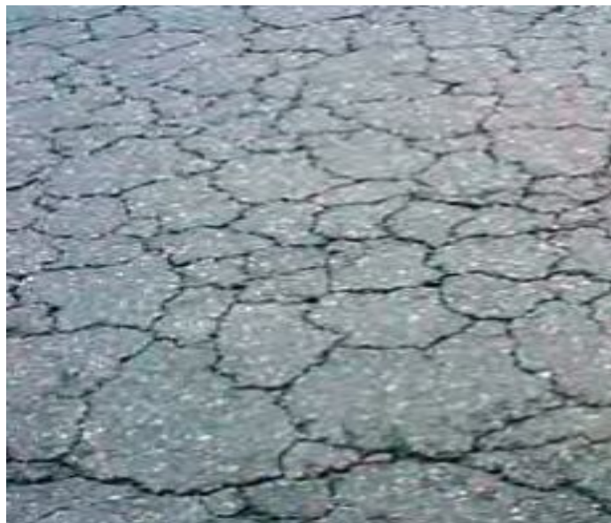
Figura 4: trincas em blocos
