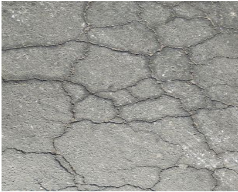
Figura 3: trincas em blocos
