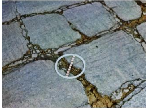
Figura 7 - Trinca interligada tipo bloco
