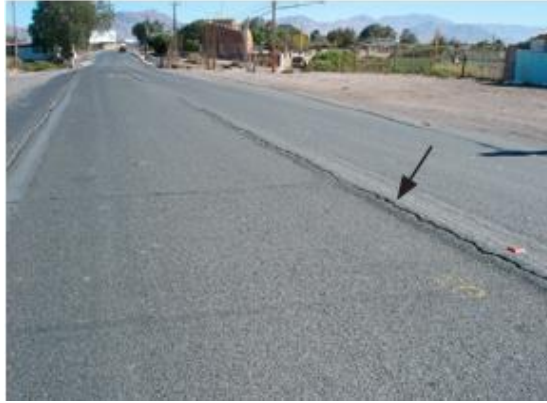
Figura 5 - Trinca de retração
