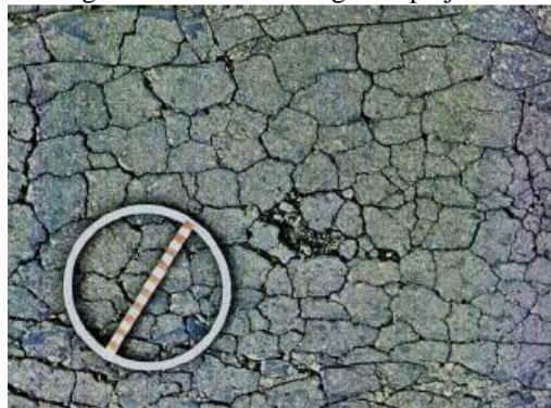
Figura 6 - Trinca interligada tipo jacaré
