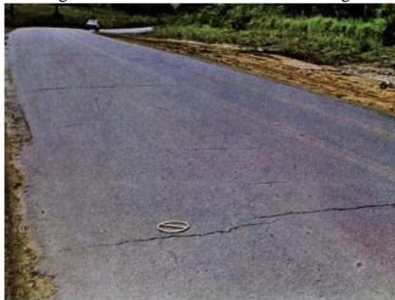
Figura 3 - Trinca isolada transversal longa
