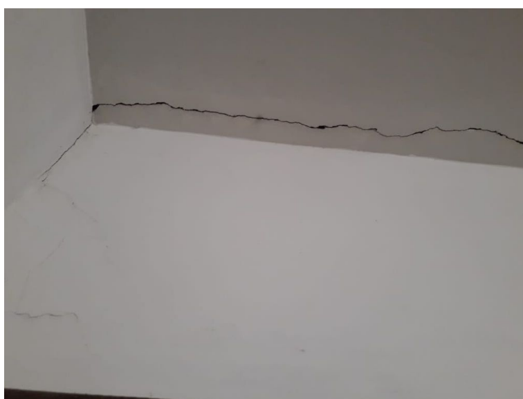
Figura 4 - Rachadura no teto
