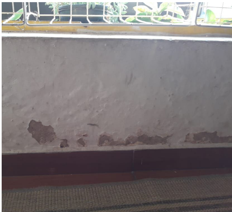
Figura 5 - Infiltração parede interna
