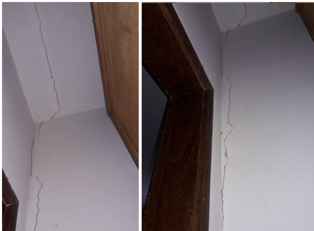
Figura 3- Rachaduras no teto e parede interna
