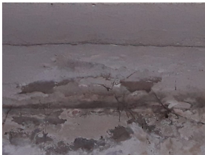
Figura 7 - Infiltração na viga de sustentação
