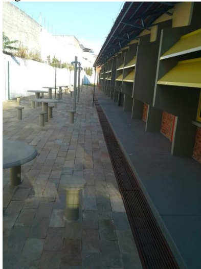
Figura 03- Canaleta instalada no bloco E.
