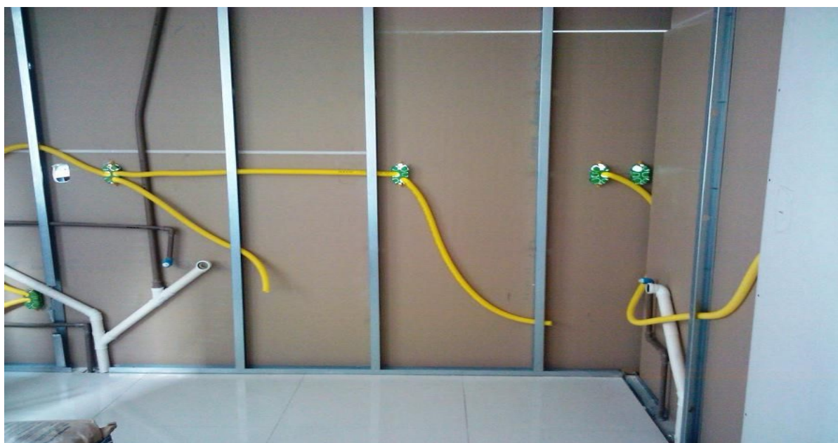
Figura 5 - Instalações elétricas e hidráulico-sanitárias no LSF
