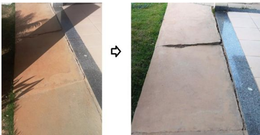
Figura 3 - Rachadura no passeio de concreto na frente do imóvel
