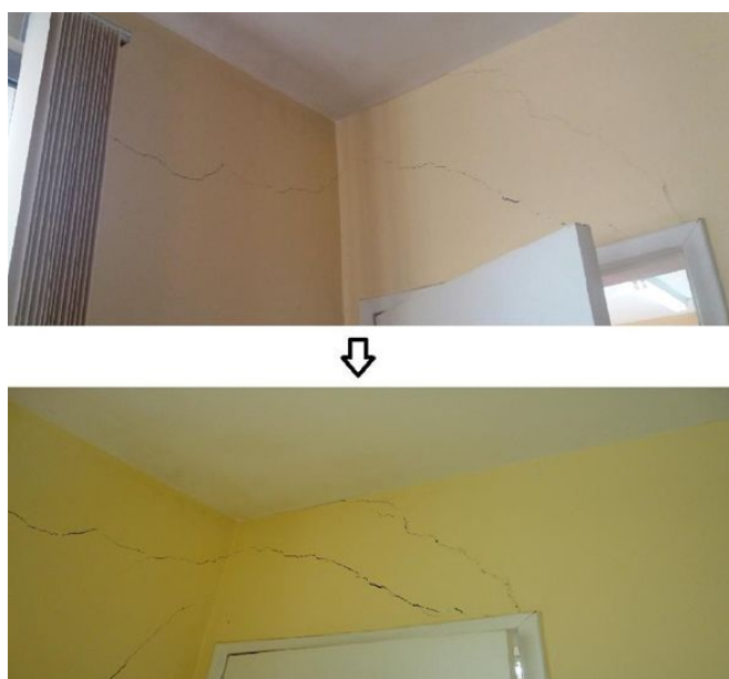
Figura 1 - Trincas na parede interna do imóvel (escritório)
