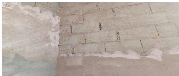
Figura 2: Emboço em parede residência CG1.
