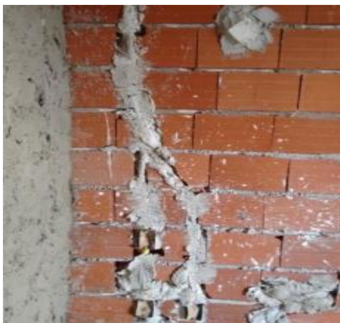
Figura 37: Cortes realizados na alvenaria tradicional para passagem de dutos.
