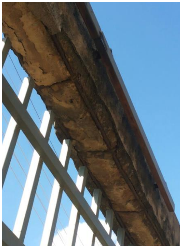
Figura 14: Estrutura danificada por ações do ambiente, apresentando uma degradação tanto do concreto como do aço.
