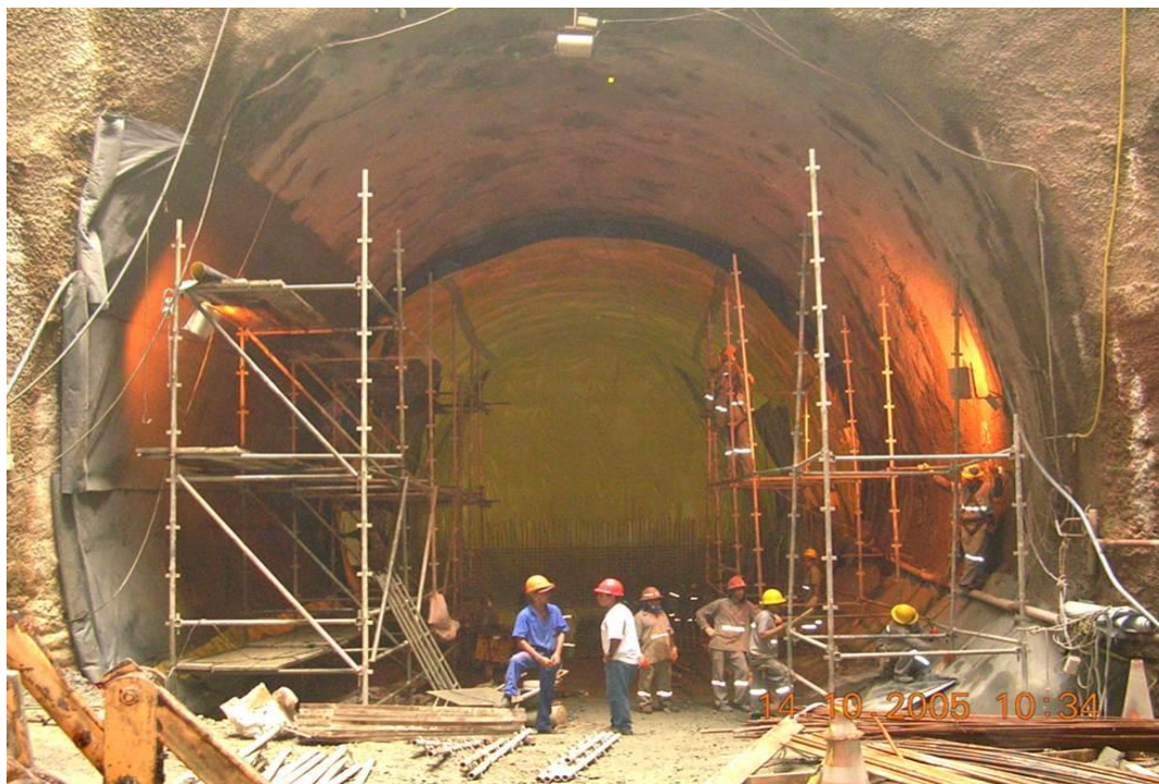
Figura 63: Recuperação da estrutura do Metrô com a utilização de Geomembrana de PVC, Libra 4 Amarela – SP
